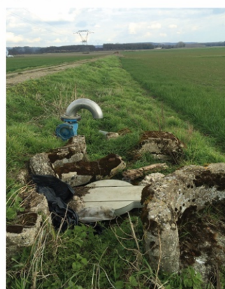
Photographie n°4 : Canalisations encore existantes du réseau des eaux usées (Morgane Flégeau, 2016)
