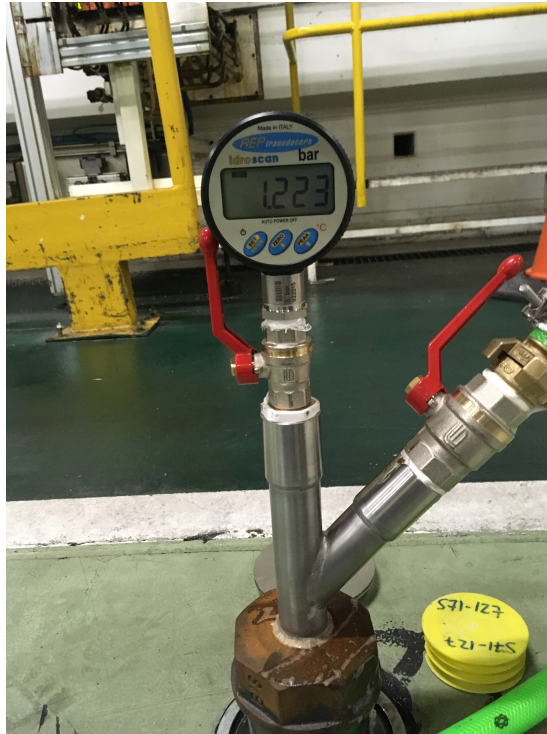
Figure 6.3 : Appareillage permettant la mesure de pression en tête de puits
