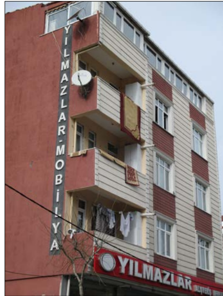
Sur les balcons de cet immeuble, protégées dans des placards, des chaudières individuelles à ventouse ont été installées.
