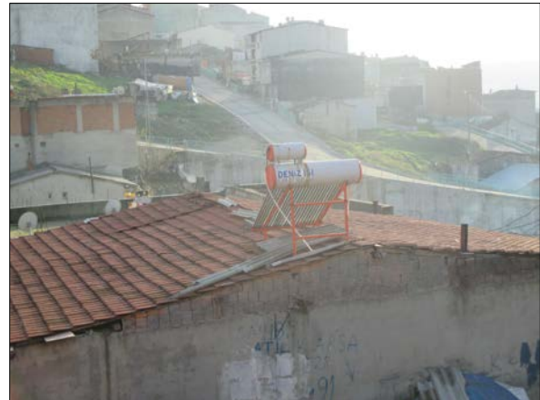
Libération des fumées polluantes dans l'atmosphère. Visibles sur le toit de cet immeuble, les chauffe-eaux solaires sont très rarement utilisés dans ces quartiers.
