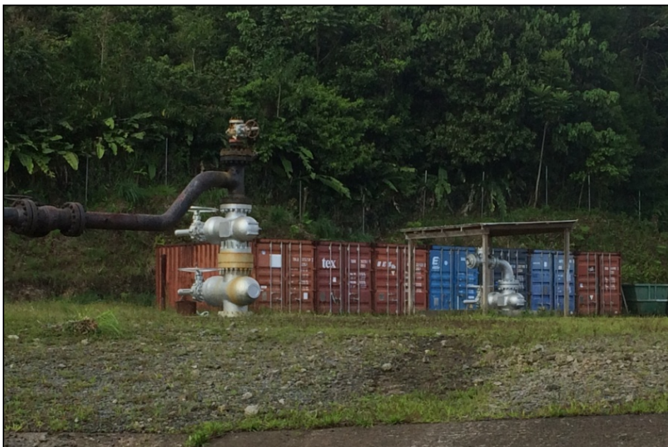
Figure 54 : Photographie de l'installation géothermique dans la vallée de Roseau, photo prise le 11/03/2017
