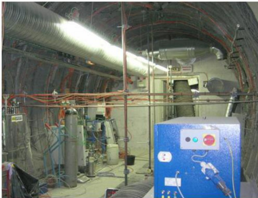
Figure 20. Photo de l'intérieur de la galerie SDZ (Théophile GUILLON, « Comportement hydromécanique des argilites du Callovo-Oxfordien lors de cycles de désaturation-resaturation » Thèse de doctorat, Nancy-Université, Institut National Polytechnique de Lorraine, Nancy, 2011, p.112)
