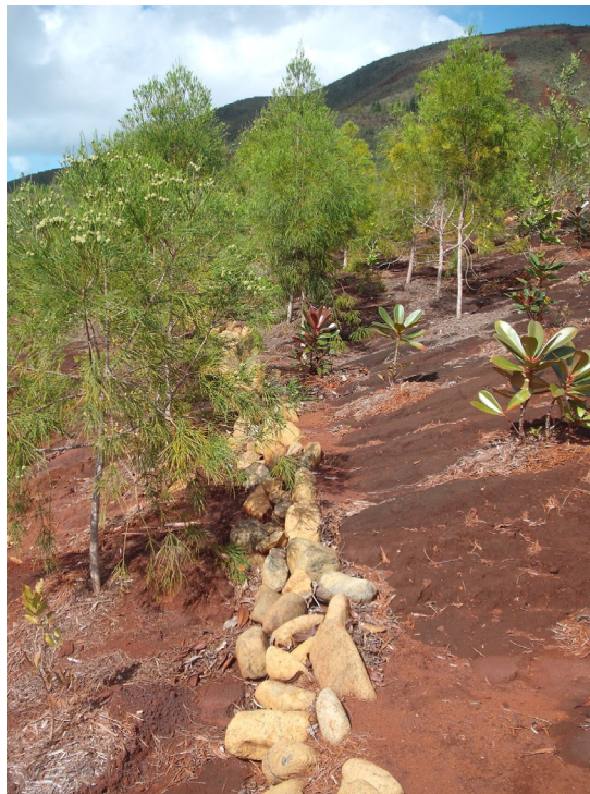
Figure 24 – Exemple de cordon rocheux mis en place sur zone compactée (photos : J. Demenois à la Coulée, aménagement DDR province Sud)
