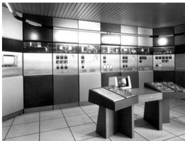
Figure 1.1 : Exemple de salle de contrôle
