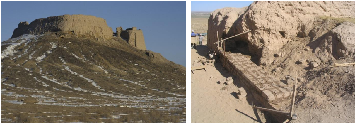
La forteresse d'Ayaz Khala. A droite pendant les travaux de conservation préventive en 2006 (Photo. D. Gandreau)
