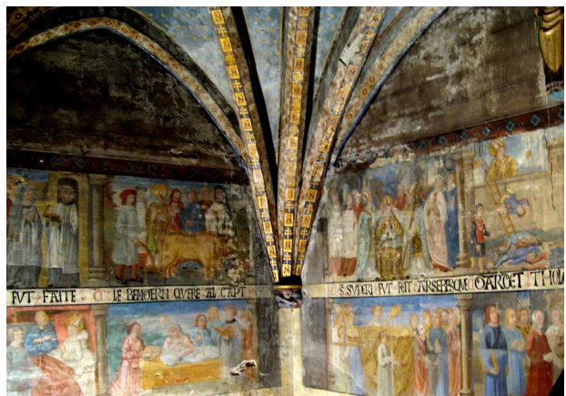
Figure 356 : Les variations thermo-hygrométriques ont entraîné la fragilisation des enduits et la cristallisation de sels en surface. Les conséquences sont encore visibles sur départ des voûtes de la chapelle Saint-Exupère de Blagnac.
