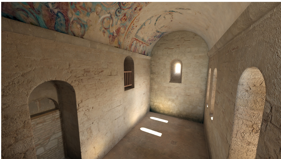
Figure 433 : Vision de la chapelle au XIX e siècle vers l'est. La dépose du plancher et les nombreuses ouvertures ont provoqué une instabilité du microclimat, affectant la conservation des peintures.
