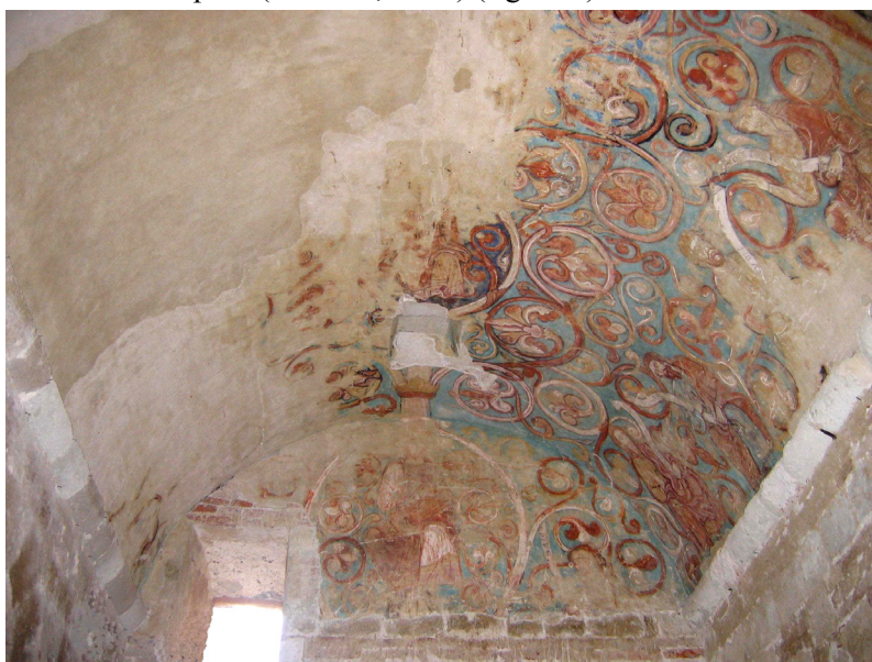
Figure 377 : Voûte de la chapelle de Moissac. Perte de la moitié sud des décors à cause de l'ouverture de la fenêtre du mur ouest.
