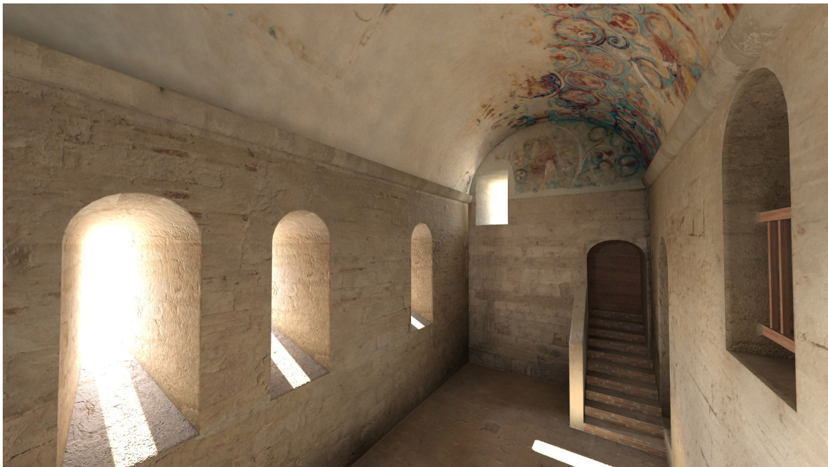
Figure 432 : Ouverture d'une fenêtre dans le mur ouest. La lumière et l'air qui entrent par cette ouverture ont asséchés l'enduit et causés la perte des décors du côté sud de la voûte.
