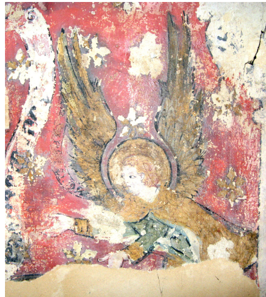
Figure 352 : Perte de certains motifs floraux (certainement métalliques) qui parsèment le fond de cette scène des peintures funéraires d'Arnaud Puyehaut, cathédrale Saint-André de Bordeaux. Dans le bas de l'image la lacune a été comblée par un enduit neutre.
