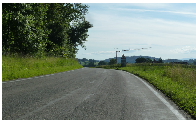
FIGURE 1.6 – Dévers inadéquat en virage
