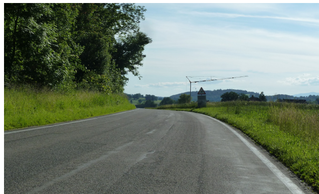
FIGURE 1.6 – Dévers inadéquat en virage
