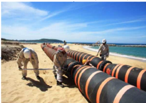
Transfert des hydrocarbures
