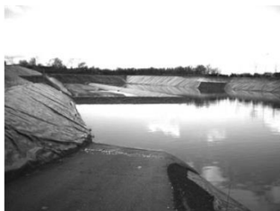
(a) Bassin de stockage-décantation extensif (Bassin Django Reinhardt à Chassieu, Photo : OTHU)
