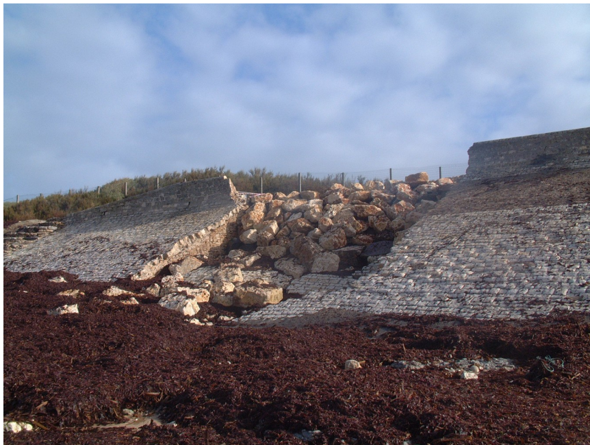
Figure 54. Réparation d'urgence de la digue des Doreaux à Saint-Clément-des-Baleines (Photo : Jean Maurin, 05/11/02)
