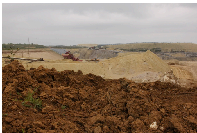
Photographie I-2 : Travaux de terrassement sur le centre d'enfouissement de déchets au Plessis-Gassot, en Plaine de France (F. Roussel, 2015).
