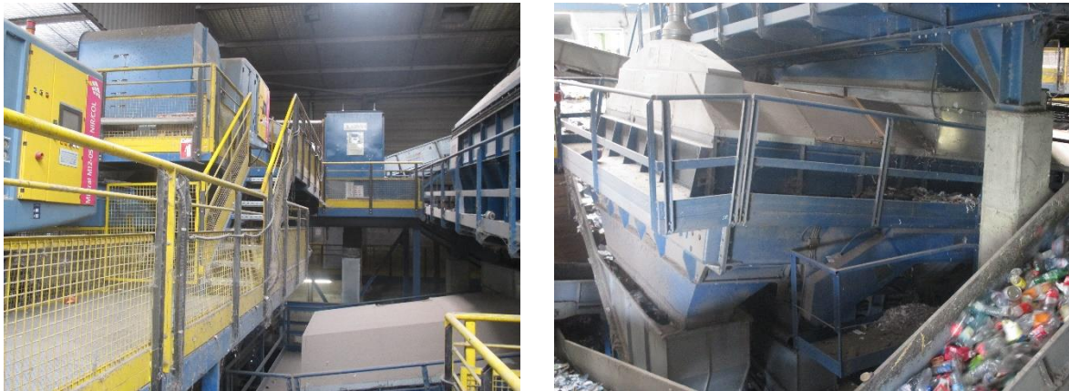
Fig. 25 : Cabines de tri optique et lignes de tri au centre de tri Lyon Sud - Nicollin (juin 2015)
