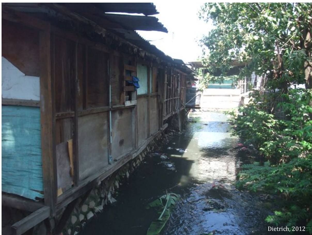
Photographie 4 : Construction précaire (en bois) exposée aux inondations dans un kampung dégradé de Bekasi, Juin 2012
