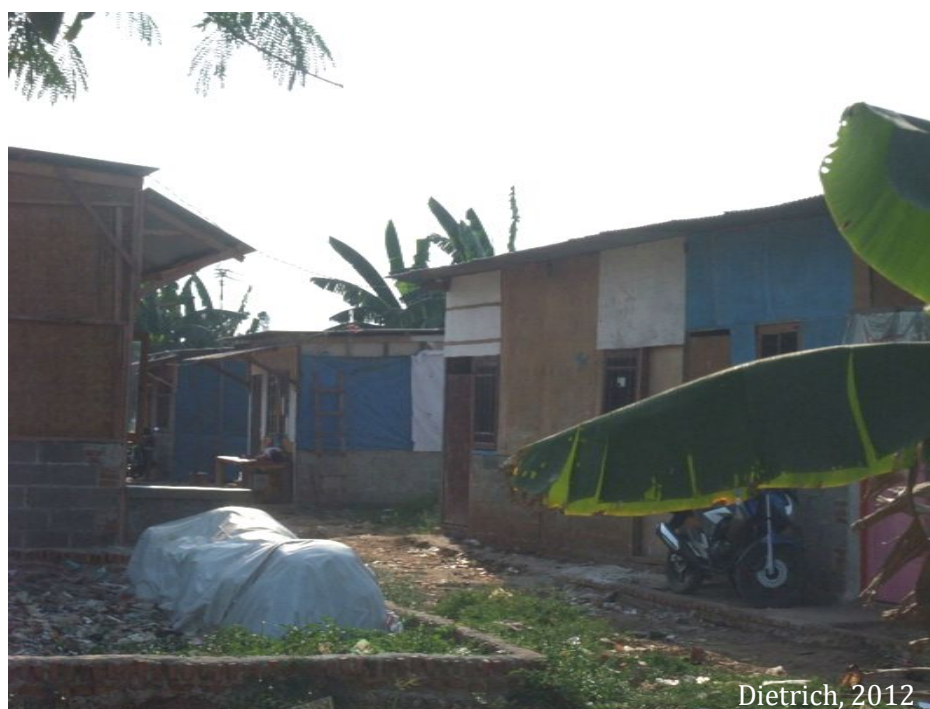
Photographie 13 : Maisons en construction à Bintara par le groupe de ménages venus de Cipinang
