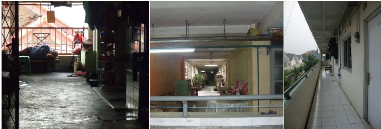
Photographies 12 : Les couloirs des logements sociaux : des appropriations différenciées. a et b : des espaces investis dans les immeubles des logements sociaux de Senen (couloirs) c : les couloirs du bâtiment de Bekasi sans occupation manifeste
