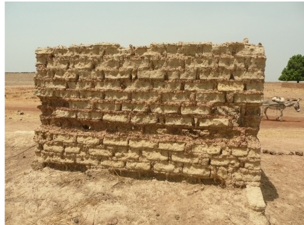
Briques plus fragiles que le mortier
