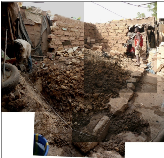
Figure 53 - Mise en tension de la corde qui dessinera la ligne droite des murs
