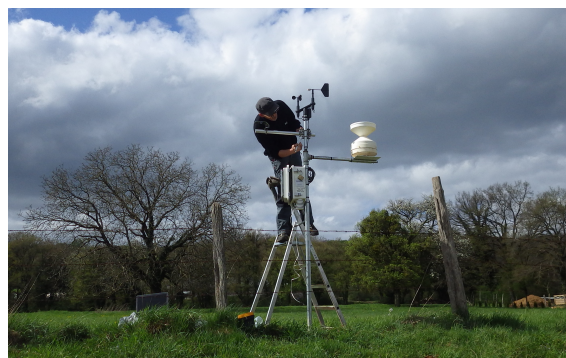
FIGURE II.29 – Installation de la station météorologique au niveau du village de Fontenotte
