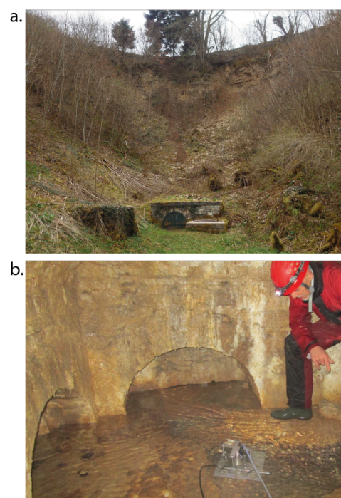
FIGURE II.14 – Captage de la source du Dahon (a) et fond du captage avec les arrivées d'eau (b)
