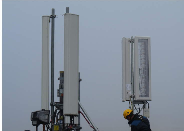
FIGURE 1.32 : Site sur la terrasse de l'agence de Bouygues Telecom à Nantes avec deux antennes classiques à gauche et deux antennes transparentes fabriquées par RFS Lannion à droite
