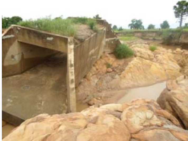
Photo 6: Route coupée sur l'axe Malanville –Tomboutou Prise de vue : KOUMASSI ; 2012
