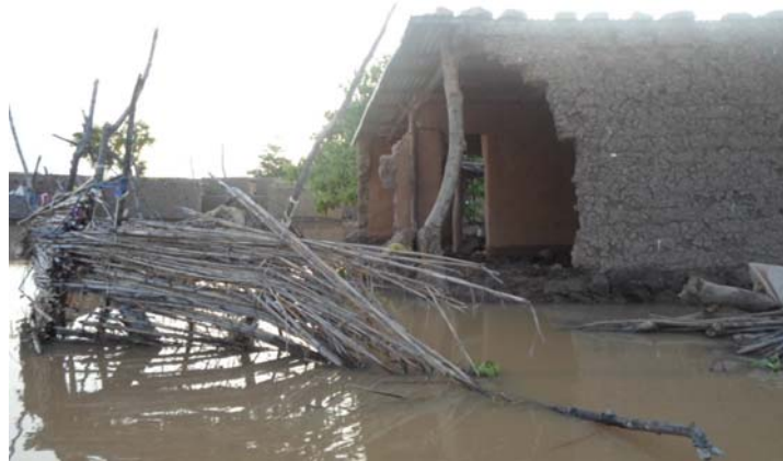
Photo 7: Habitation écroulée dans le village de Kassakou Prise de vue : Koumassi, 2012
