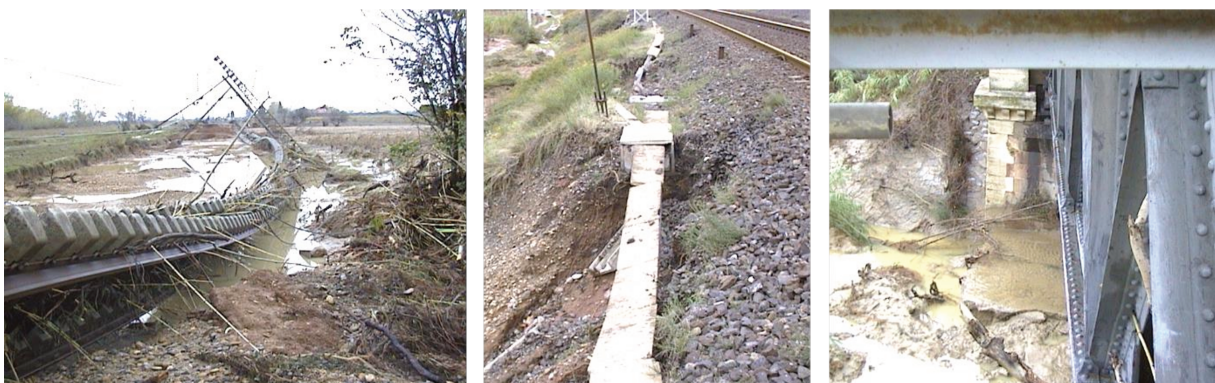
Figure 1.1. Photos de dommages aux ouvrages ferroviaires sur la ligne de Bordeaux à Sète, dus à l'inondation de 1999 dans l'Aude (Crédits photos : SNCF Réseau)
