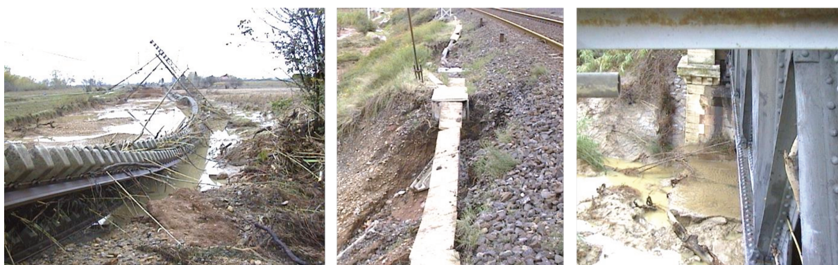
Figure 1.1. Photos de dommages aux ouvrages ferroviaires sur la ligne de Bordeaux à Sète, dus à l'inondation de 1999 dans l'Aude (Crédits photos : SNCF Réseau)
