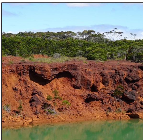
Figure 21 : Tassement et érosion mécanique des latérites sous la cuirasse indurée à l'origine d'une voûte cuirassée et de la formation d'un vide sous cuirasse, secteur de Goro.
