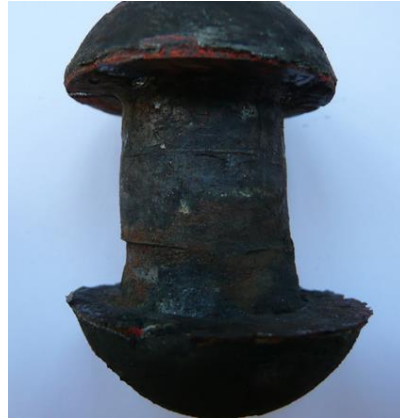
Figure 2: Ovalisation du perçage observée sur ouvrage riveté ancien (ouvrage de Pussy, CEREMA Lyon)
