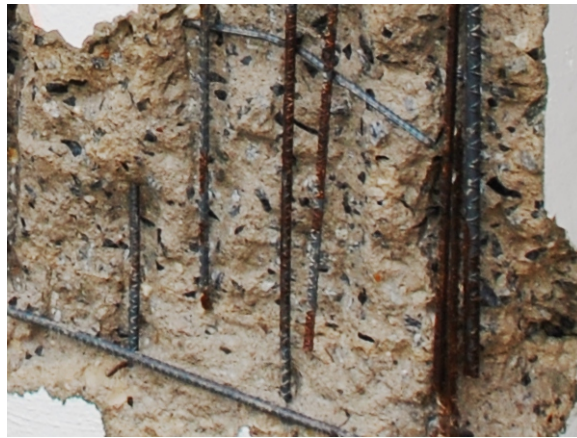
FIGURE A.6 – Les armatures du béton armée apparaissent et le béton s'est écaillé.
