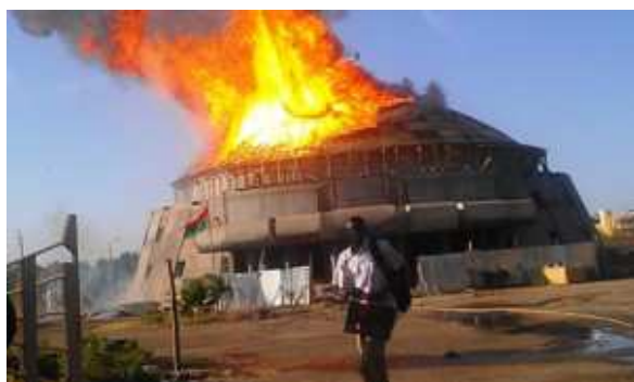
Figure n°18 : image de l'incendie du bâtiment de la MICA en construction
