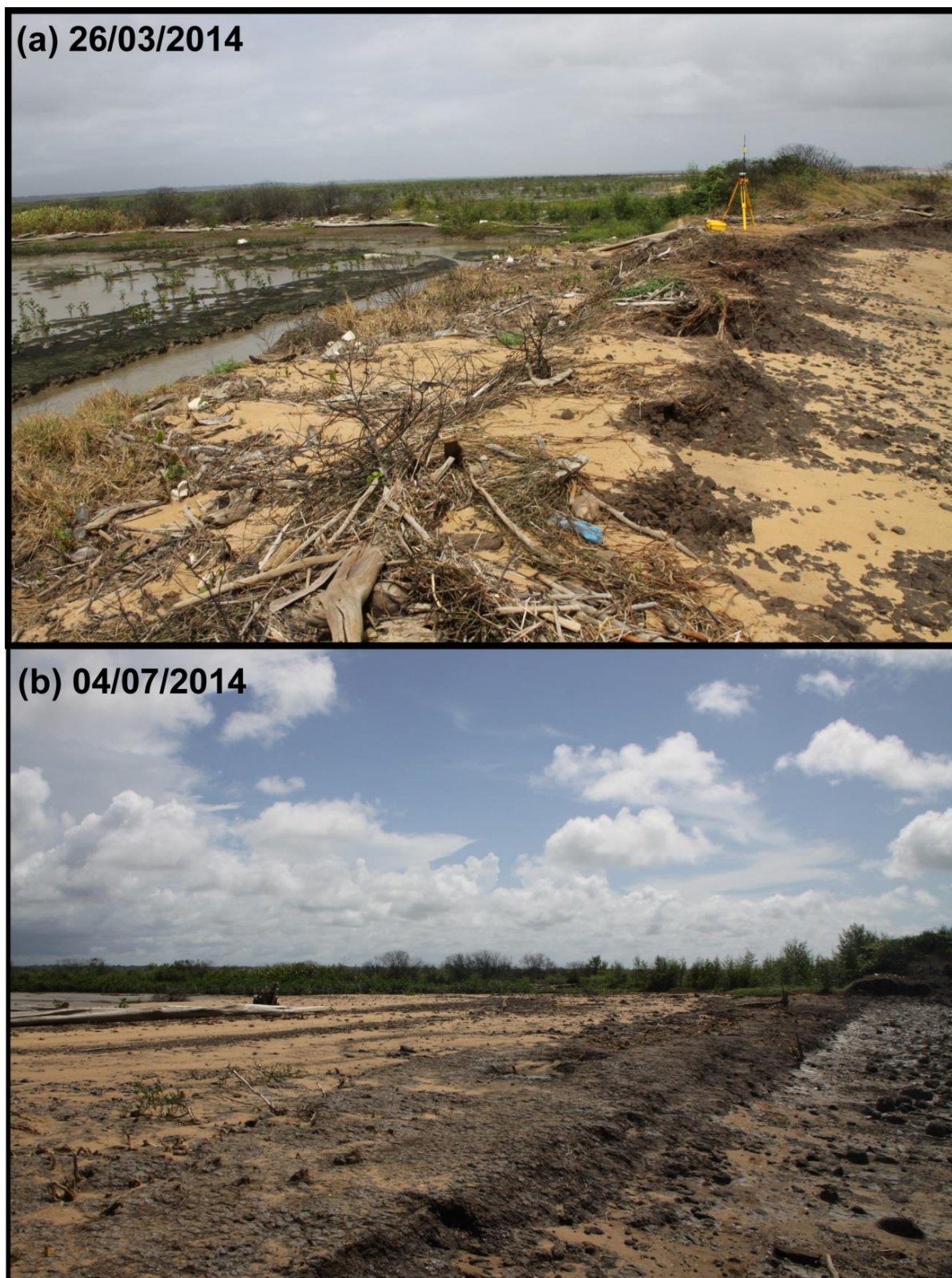
Figure 58 : Photographies de la brèche dans la digue Sud de la parcelle.
