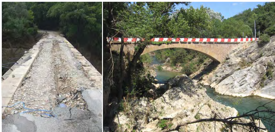
FIGURE 1.6 – État du pont de la Tournavelle, sur l'Argens, en aval du quartier des Badiés, sur la commune des Arcs-sur-Argens à la suite de l'inondation du 15 juin 2010. L'eau est passée près de 2 m au-dessus du pont, détruisant la chaussée et arrachant les garde-corps (photo à gauche, C. MARTIN, août 2010 et photo de droite, Cécile MARTIN, juin 2010), d'après Martin (2010)
