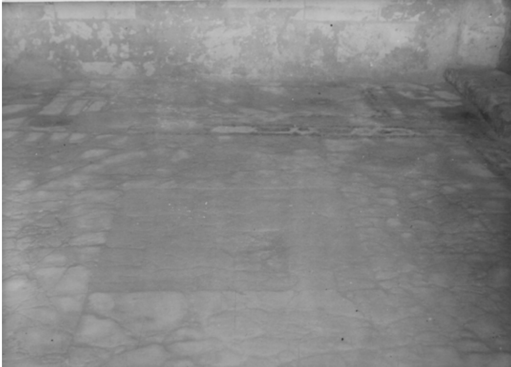
Abb. 341. Zerstörter Fußbodenbelag des Vestibüls, 1904 (SCA).
