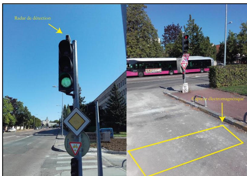
Figure 1.24 : Illustration des dispositifs de détection autonomes pour les feux tricolores sur un même carrefour entre le Boulevard Gabriel et l'Avenue Alain Savary (à gauche : un radar de détecteur de présence ; à droite : un capteur électromagnétique)
