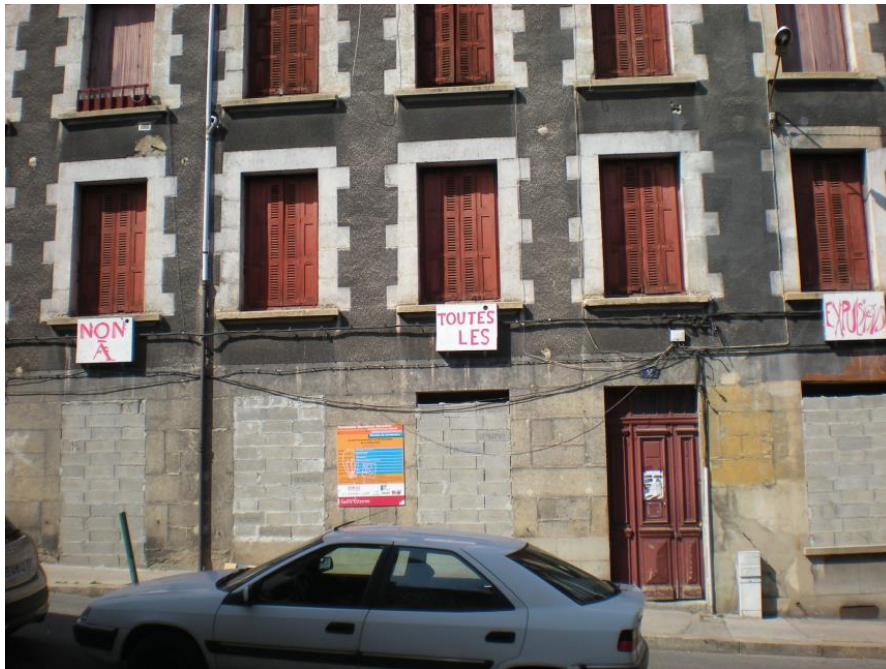
Figure 94 : Maison murée et squattée dans le quartier Beaubrun à Saint-Etienne
