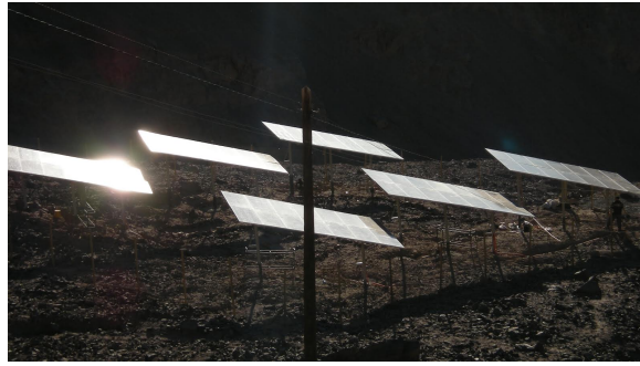
Figure 1.3 – Les panneaux solaires du projet de Huatacondo
