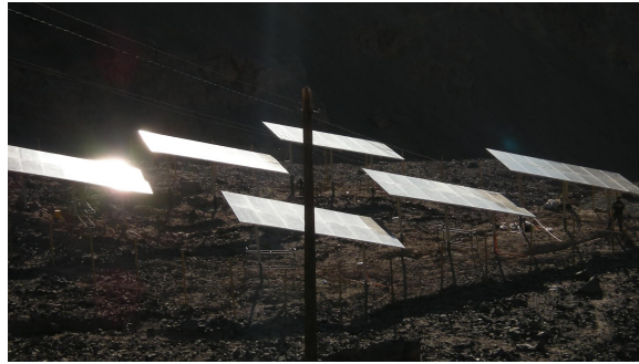
Figure 1.3 – Les panneaux solaires du projet de Huatacondo
