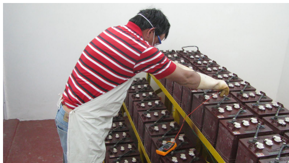
Figure 1.2 – La batterie du projet de Huatacondo
