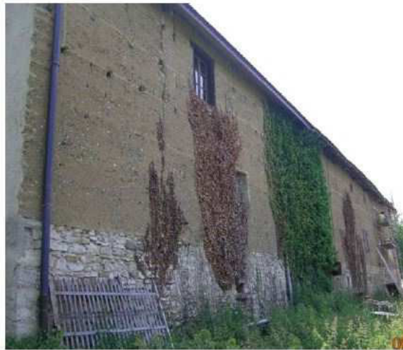
Figure 1-7 : Maison en pisé datant de la fin du 19 ème siècle avec un soubassement en maçonnerie de pierres
