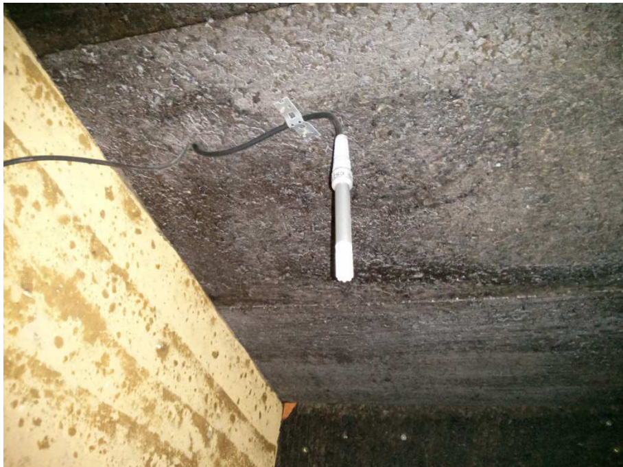
Figure 4-7 : Mesure de la température et de l'humidité relative dans l'ambiance avec une sonde CS215
