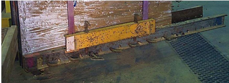
Figure 4-1 : U et tirants permettant de soulever le mur en pisé après sa fabrication
