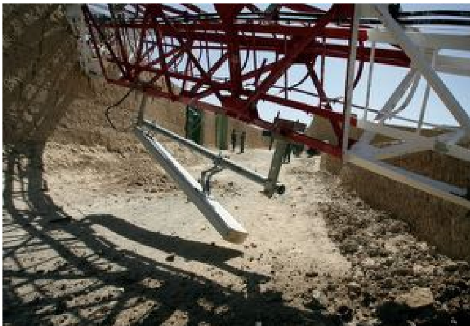
Figure 4 - Photo illustrative de l'article du New York Times « U.S. Underwrites Internet Detour Around Censors » publié (en ligne) le 12 juin 2011. Légende : “The mobile antenna of a telecommunications tower outside Ghazni that was attacked by Taliban militants this month” . Crédit : Rahmatullah Nikzad/Associated Press - 2011.
