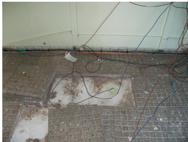
Figure III.9 : Capteurs de mesure de température et flux au niveau du plancher
