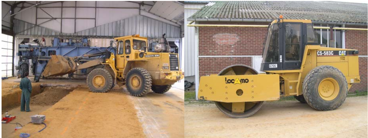
Figure 7.4 : Mise en œuvre d'une couche de limon (à gauche) et compacteur utilisé (à droite).
