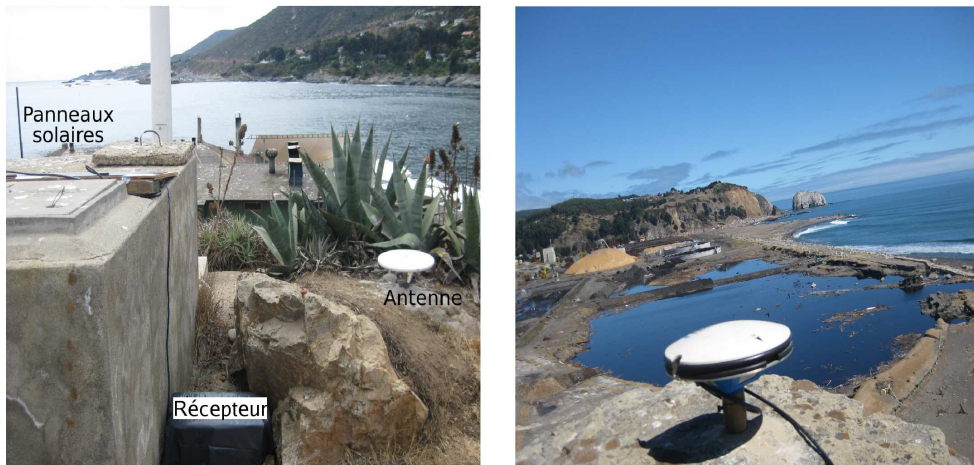
FIGURE 2.11: Photographies des installations réalisées pendant la mission postsismique française. Gauche : station semi-permanente de Zapallar ( 32.5^{\circ}\text{S} ) au Nord de la terminaison de la rupture, équipée de panneaux solaires. Droite : mesure du point du réseau de campagne CO10 situé sur les falaises de Constitución ( 35.2^{\circ}\text{S} ). La large baie visible en arrière plan et où une papeterie était installée a été dévastée par le tsunami.
