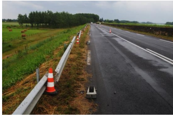
Figure 48. Glissière de sécurité dont la continuité est temporairement interrompue pour éviter des phénomènes de court-circuit.
