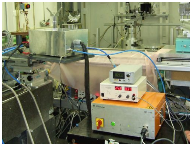
Figure 4.3: Photographie du générateur (en orange)
