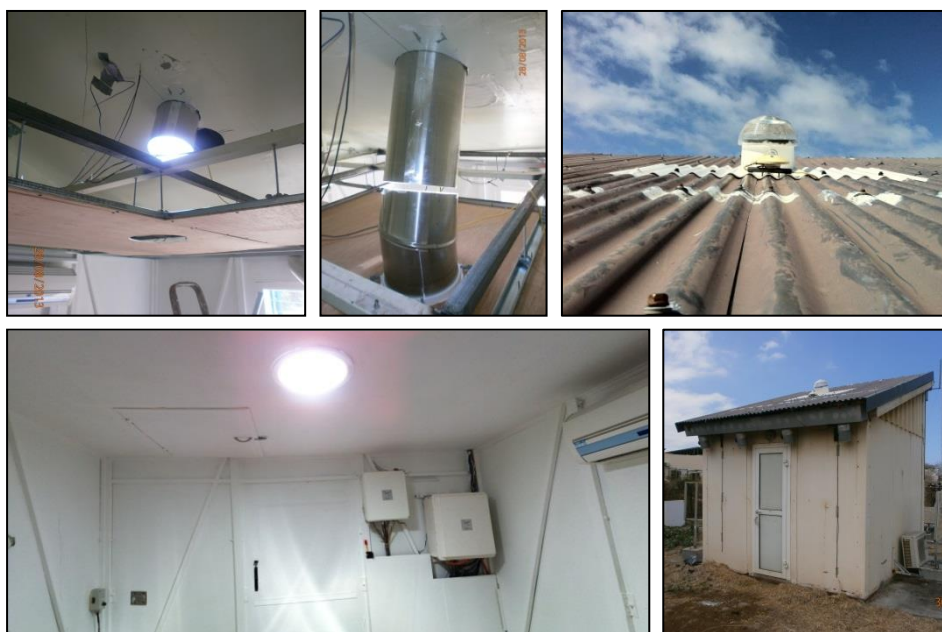
Figure 55 : Modification de la cellule LGI
