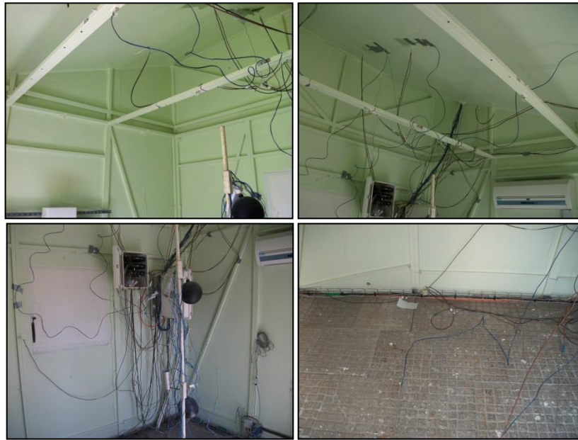
Figure 53 : Cellule LGI - Vues intérieures avant modification (Guichard 2013)
