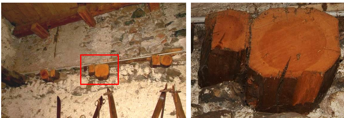
Figure 85 : Mur sud du fenil (niveau 3) où se trouve la poutre sciée 12 et détail de cette poutre (le chef-lieu, Cervières).
