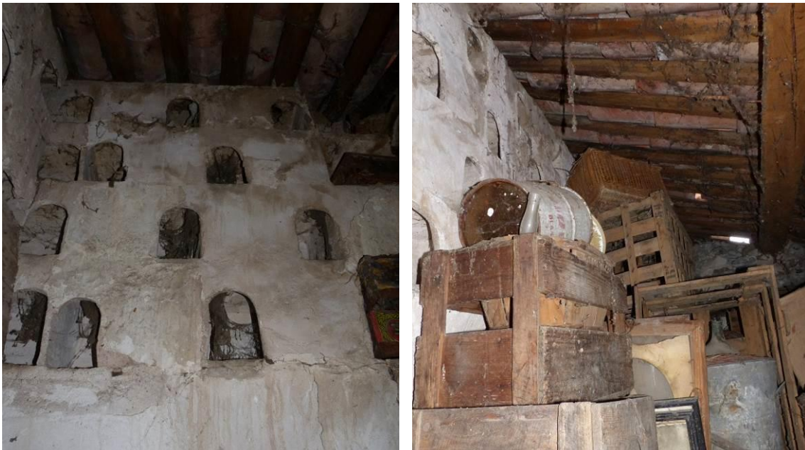
Figure 729 : Le pigeonnier est installé sous la pente sud-ouest de la toiture (deuxième étage). La majorité des boulins (ou alvéoles) se trouvent dans le mur orienté nord-ouest sud-est (aligné avec la route de Prads) (La Javie).
