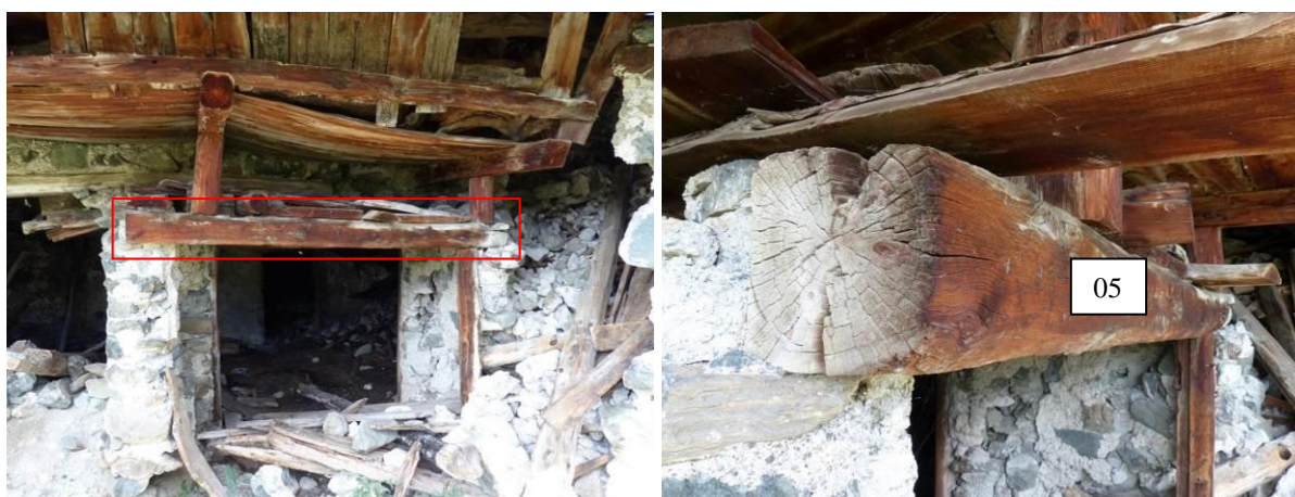
Figure 468 : Le cinquième prélèvement a été réalisé dans le linteau du porche de la façade sud-ouest, août 2014 (les Fraches, Cervières).
