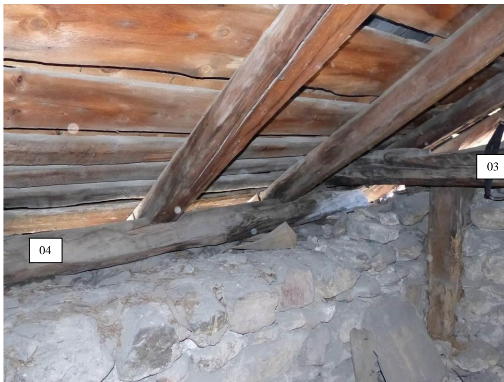
Figure 202 : Vue de l'angle nord-est des combles. L'entrait (03) de la ferme est ne repose pas sur la panne sablière (04). Voir Figure 26 (église St-Laurent, La Roche-de-Rame).
