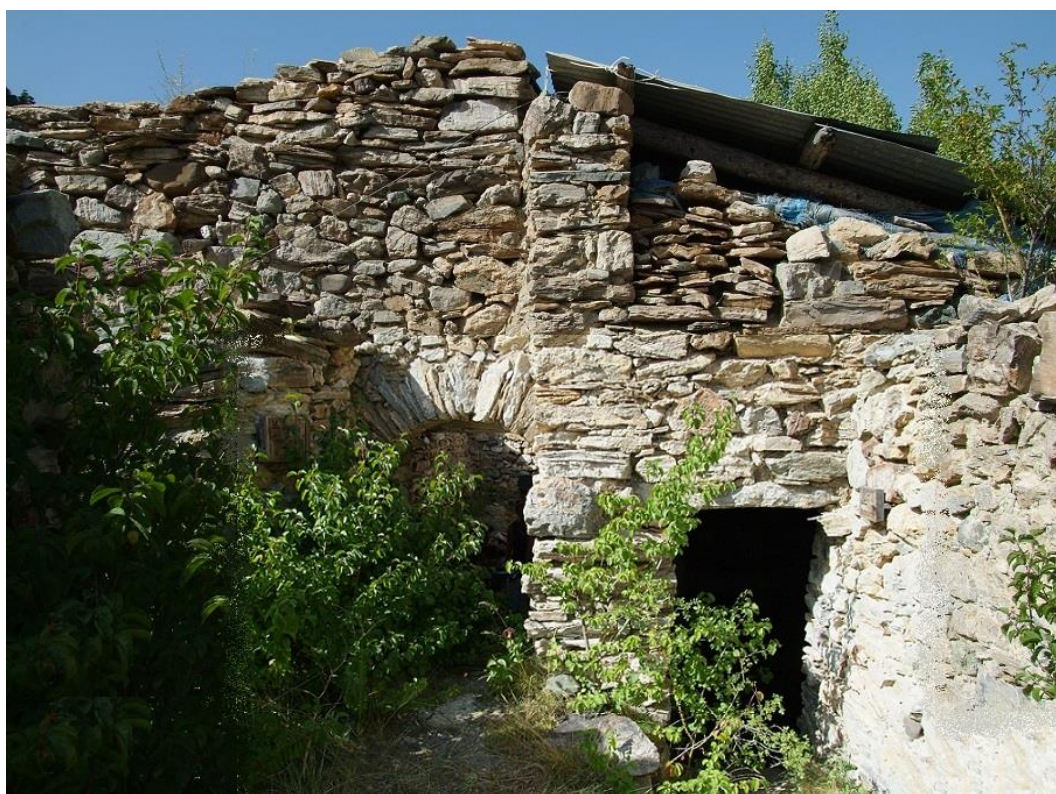
Figure 136 : Pressoir Martin Courcier B02 (0515102), façade sud-est. L'ouverture de droite donne accès au pressoir.
