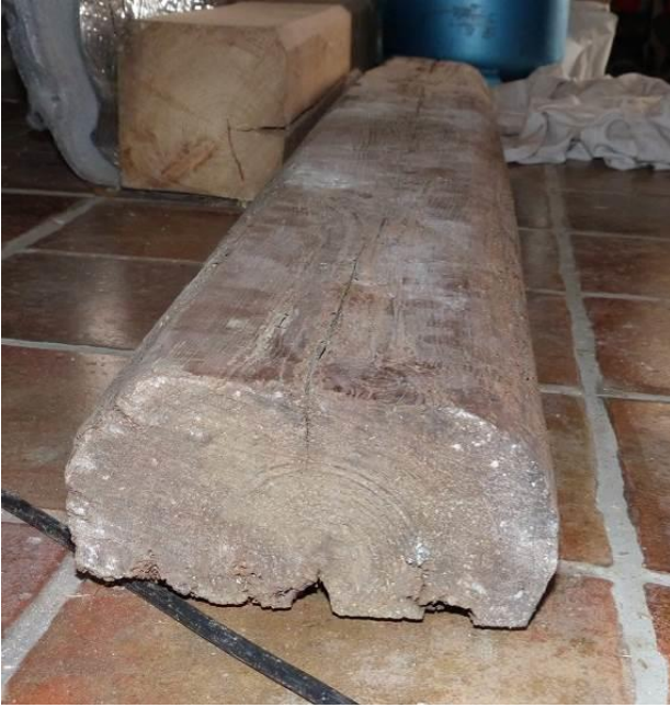
Figure 681 : Détail de la poutre déposée 0415504_15 (Chanolles, Prads-Haute-Bléone).
