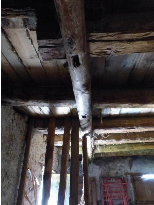
Figure 32 : N+1, vue vers l'ouest. Détail de la poutre (orientée est-ouest) soutenue à l'est par la décharge 19. Les mortaises aujourd'hui non employées indiquent que cette pièce de bois avait autrefois une fonction différente. Il s'agissait sans doute de la sablière haute d'une cloison en pan de bois, séparant la grange d'une galerie (le Serre, Val-des-Prés).
