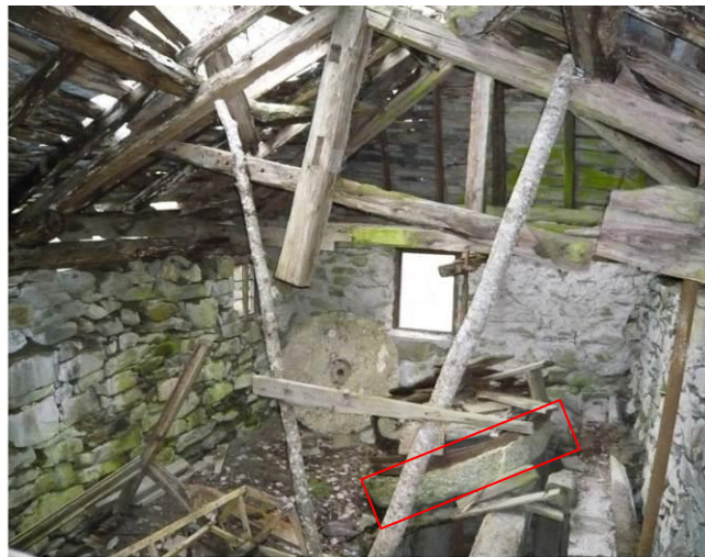
Figure 612 : Entre 1980 et 2012, la meule (dormante), et l'arbre de transmission vertical, installés dans le coin sud-ouest du moulin, ont été dégradés, sans doute suite à l'affaissement d'une des poutres de plancher (n°01 ?). La photographie de gauche (Roucaute-Heller, service de l'inventaire du patrimoine), montre l'état avant dégradation (les Viollins, Freissinières).
