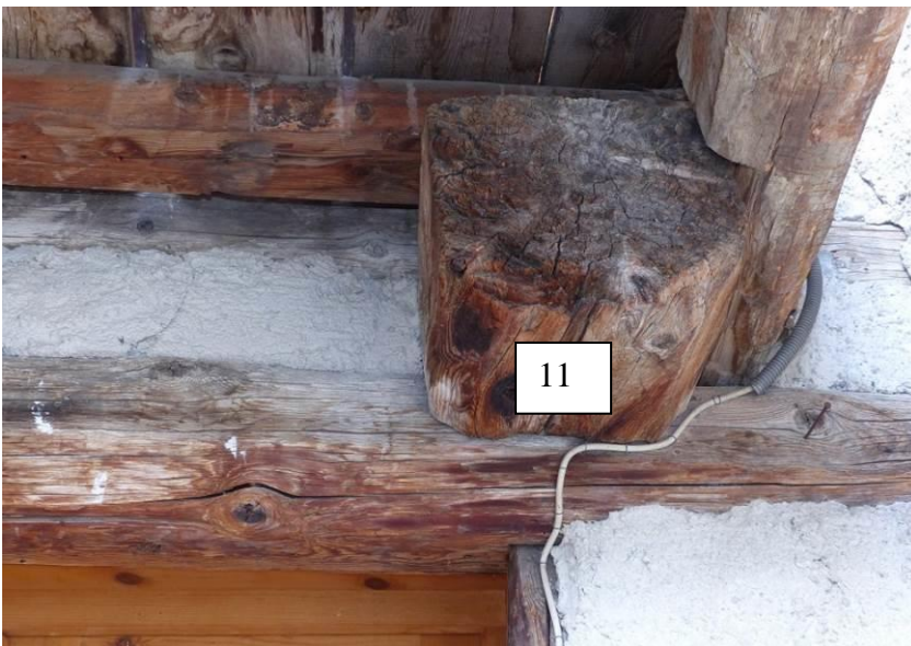
Figure 410 : Extrémité sud de la solive du troisième niveau de la maison nord (le Serre, Val-des-Prés).
