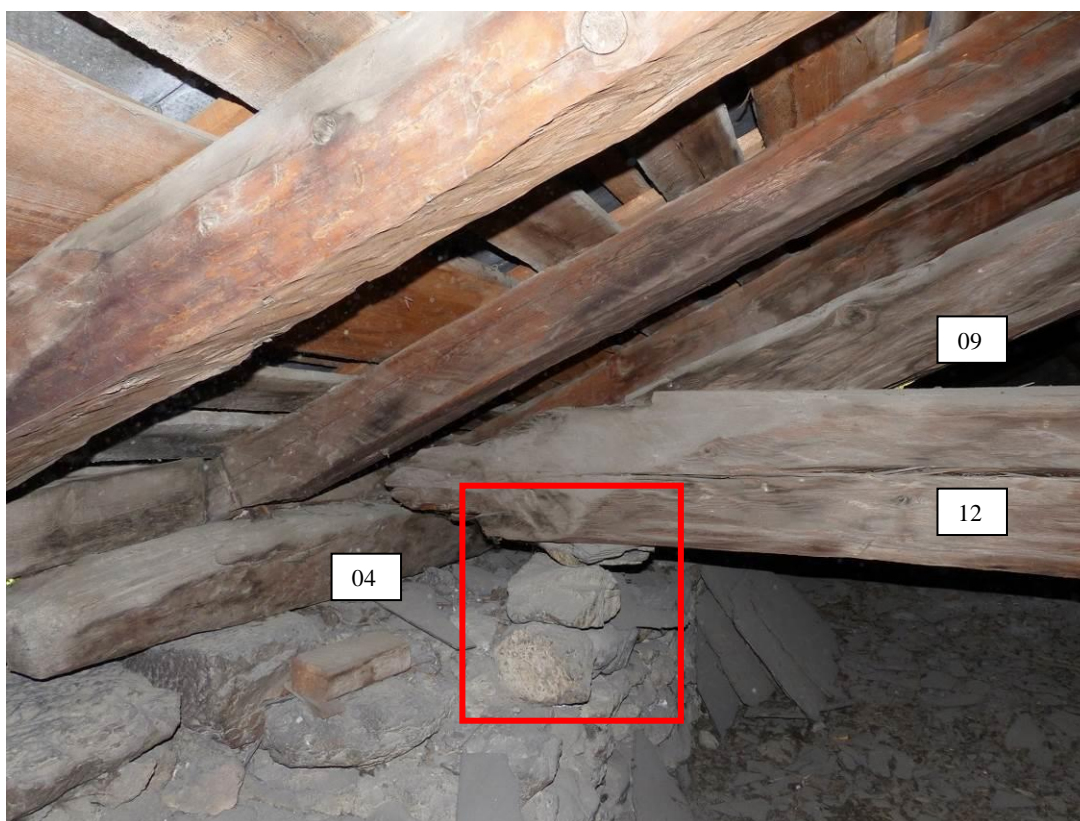
Figure 215 : Vue de l'extrémité nord de l'entrait de la ferme centrale, depuis l'ouest. Celui-ci ne repose pas sur la panne sablière nord, mais sur un empilement de pierres (église St-Laurent, La Roche-de-Rame).
