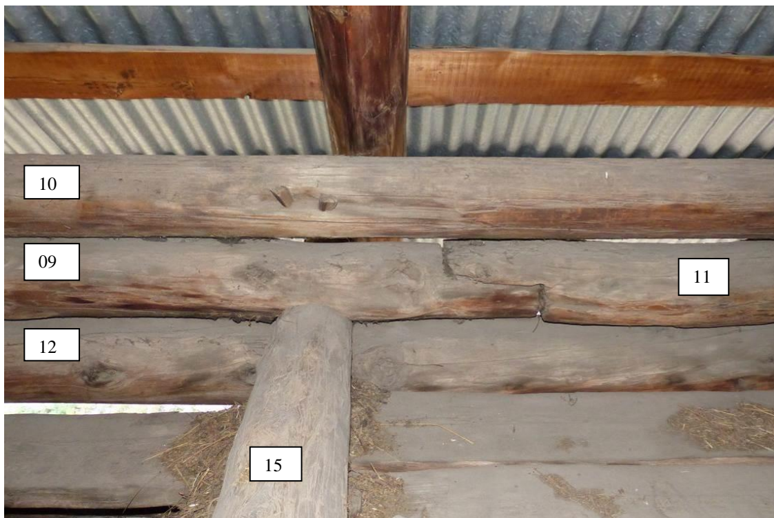
Figure 41 : N+3, détail de l'empilage sud soutenant la toiture. Les pièces de bois 09 et 11 sont assemblées à mi-bois (le Serre, Val-des-Prés).
