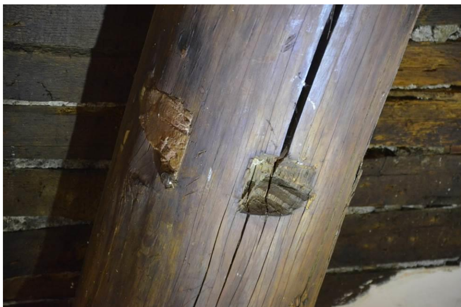
Une cavité pyramidale est creusée dans cette poutre non équarrie (P. Hoffsummer, avril 2014).
