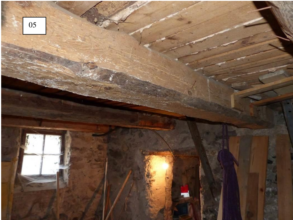
Figure 713 : Niveau 1 (caves), pièce centrale vue vers le nord-ouest (le Moulin, La Javie).
