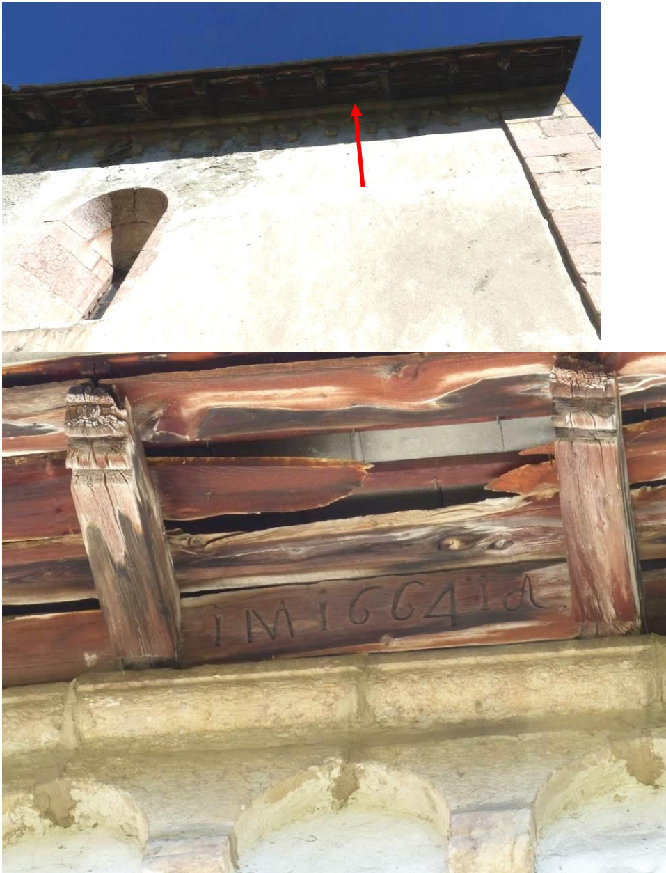
Figure 192 : Détail de l'inscription gravée sur une poutre (ou une planche : un closoir), entre deux chevrons, au-dessus du mur gouttereau sud : « i M i 664 i A ».
