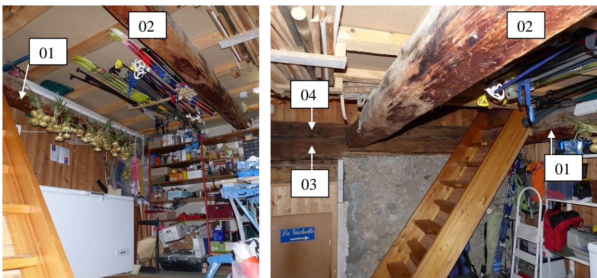
Figure 387 : Petite chambre, sous le niveau des combles. A gauche, vue vers le nord, à droite, vue vers le sud (le Serre, Val-des-Prés) (le Serre, Val-des-Prés).
