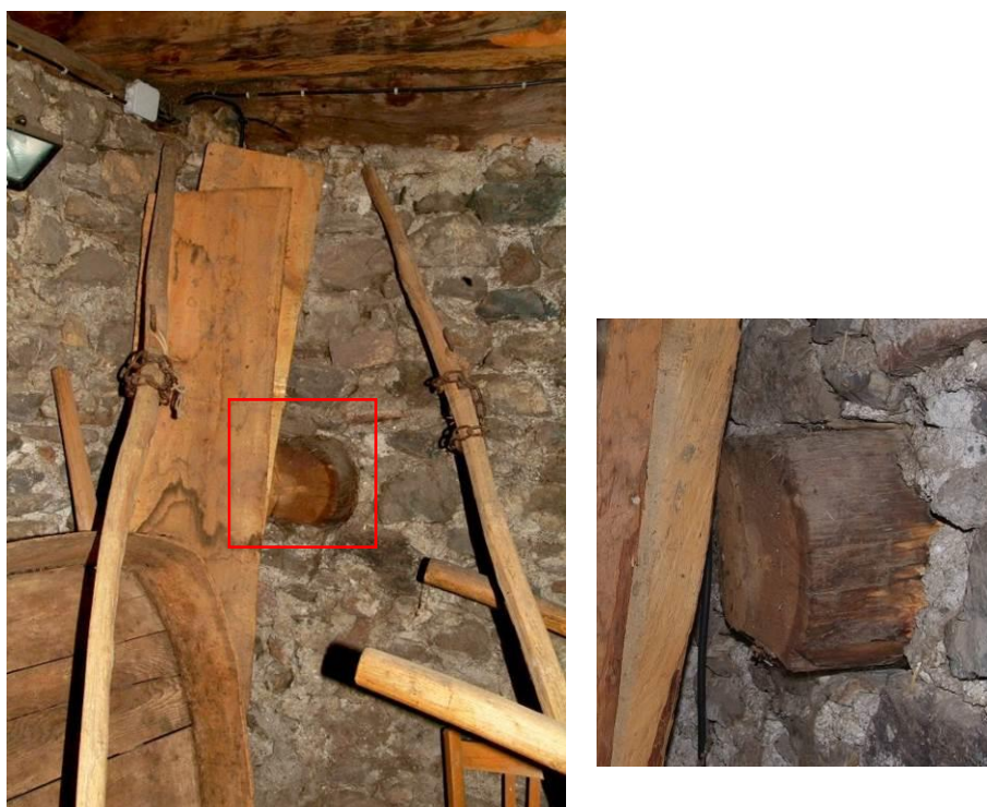
Figure 75 : Grange, niveau 4. Vue du mur ouest où se trouve la poutre sciée 05 et détail de cette poutre (le chef-lieu, Cervières).
