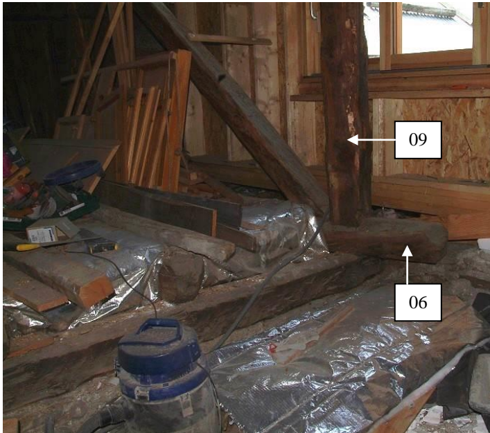
Figure 544 : La solive 06 se trouve sous le poinçon (09) de la ferme ouest (le Pinet, Puy-St-Pierre).
