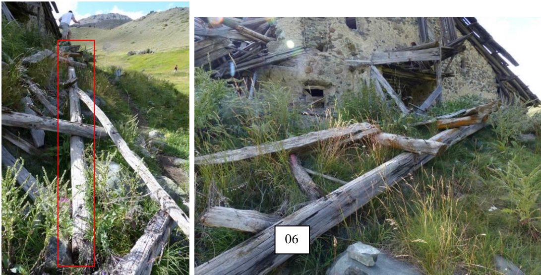
Figure 469 : Poutre erratique de 10 m de longueur, devant le mur pignon sud, sur laquelle sont encore clouées des planches débitées sur dosse, août 2014 (les Fraches, Cervières).
