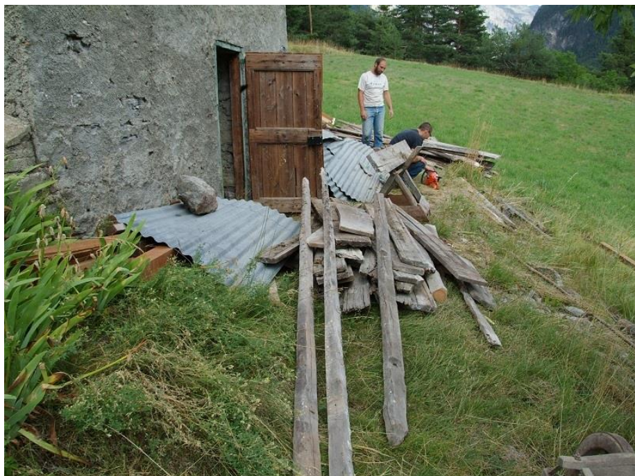
Figure 106 : Plusieurs longues poutres déposées ont été échantillonnées, qui seraient d'anciens chevrons de charpente (la Maison Crénelée, Briançon).
