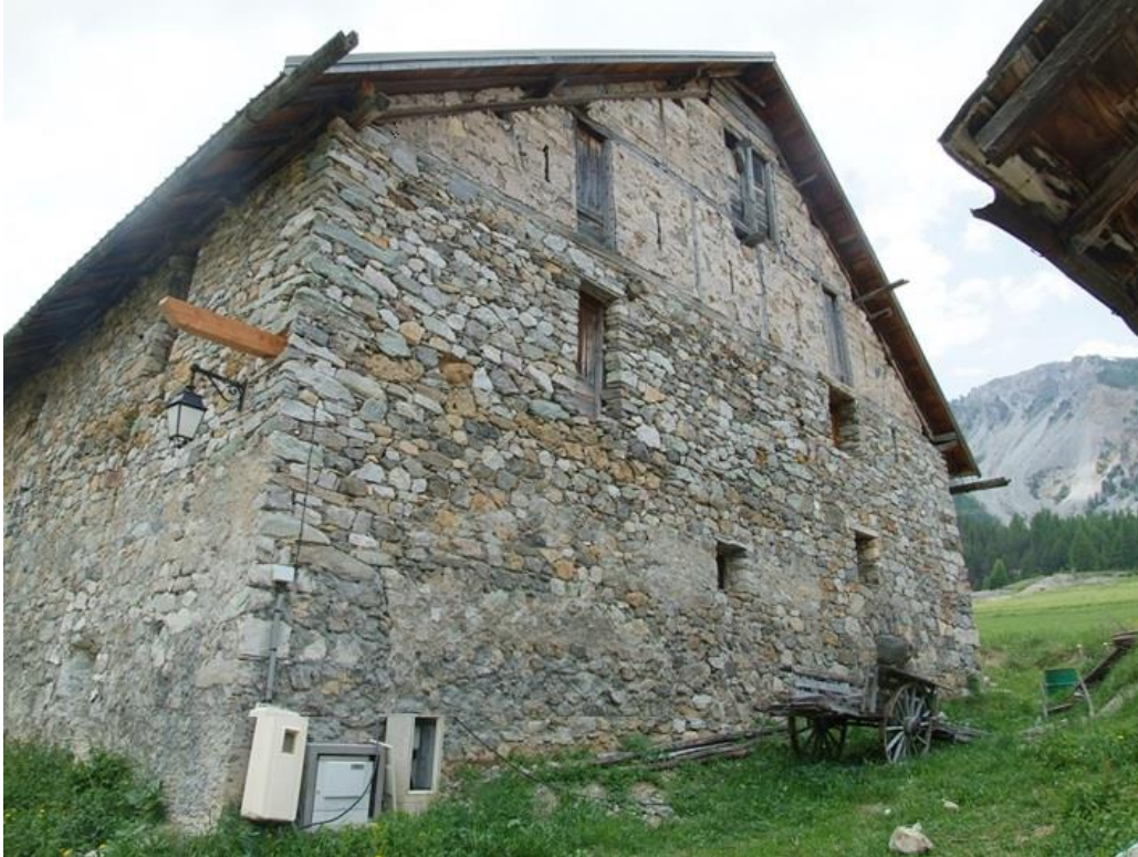
Figure 509 : Vue du bâtiment depuis le nord-est. La pièce de bois horizontale prise dans la maçonnerie du mur gouttereau est (au dessus du luminaire) soutenait autrefois l'extrémité nord d'un balcon qui courrait tout le long de cette façade (cf. photographie de 1981 où le balcon est encore en place, service de l'inventaire du patrimoine) (le Laus, Cervières).
