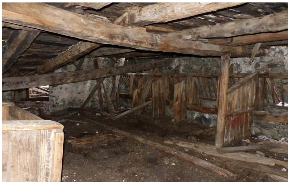
Figure 473 : Ecurie sud, vue vers le sud-ouest. Le plafond de cette pièce est partiellement effondré, octobre 2013 (les Fraches, Cervières).
