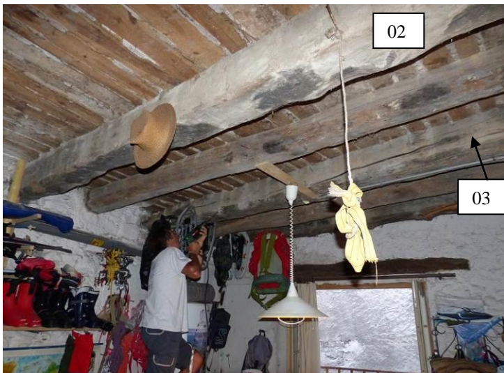
Figure 751 : Vue de la partie ouest de l'écurie, carottage de la solive 03 (La Javie).
