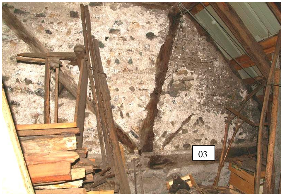
Figure 524 : Vue du pan de bois du mur pignon est, depuis le deuxième niveau de la grange. La sablière 03 est orientée nord-sud (le chef-lieu, Cervières).
