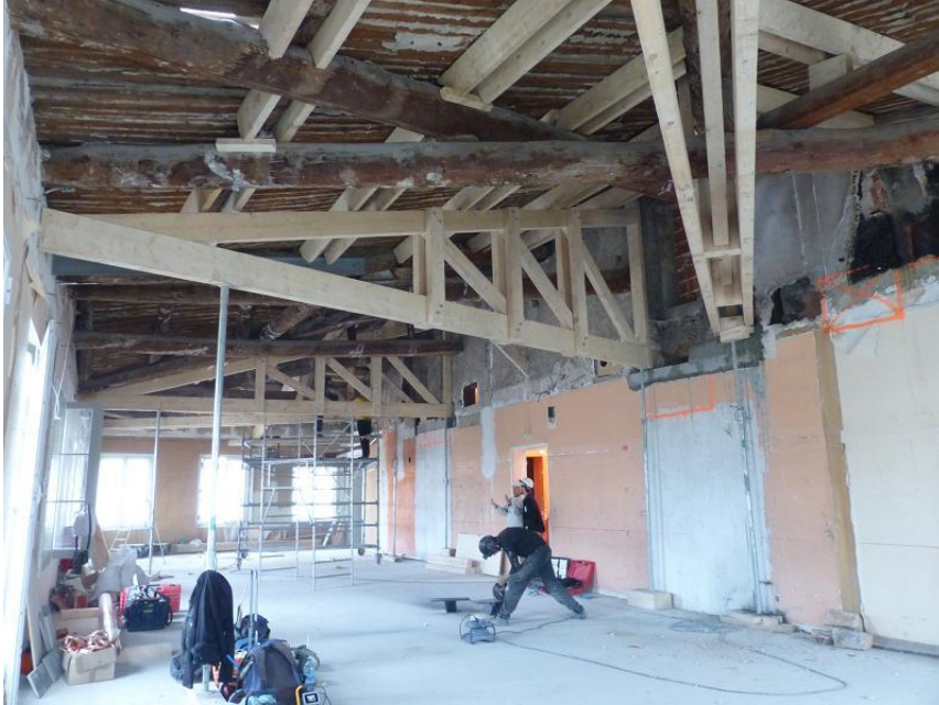
Vue d'ensemble de la salle est (premier étage) pendant les travaux (mars 2014).
