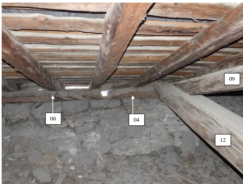
Figure 203 : Contrairement au côté sud, les deux poutres (04 et 06) constituant la panne sablière nord ne sont pas assemblées. Il existe même un vide entre leurs deux extrémités (église St-Laurent, La Roche-de-Rame).
