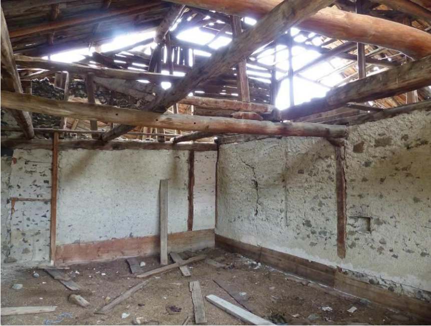
Figure 478 : Deuxième niveau, certainement l'aire de battage de la grange nord-est, vue vers le sud. C'est dans cette pièce qu'a été réalisé le prélèvement 02 (non visible sur la photographie), octobre 2013 (les Fraches, Cervières).
