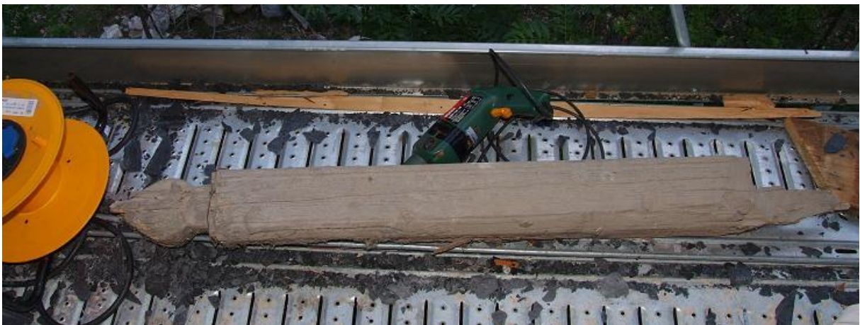
Figure 657 : Photographie de la pièce de bois 01 (Mont-Dauphin).
