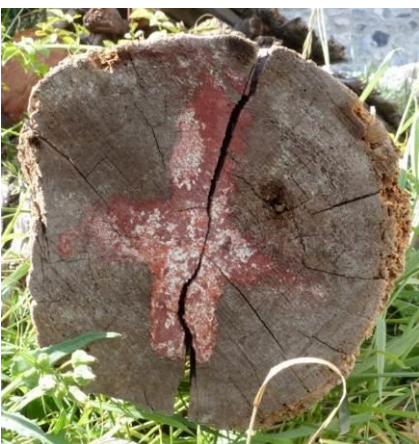
Figure 763 : Détail d'une des extrémités de la poutre 03 sur laquelle est peinte une croix rouge (La Javie).
