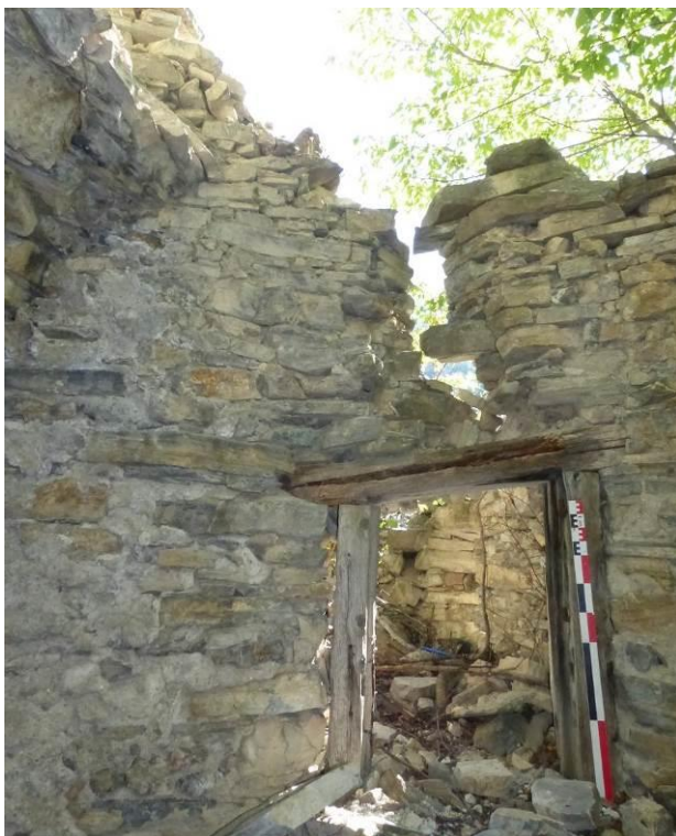
Figure 145 : Pressoir E08 (0515105), baie (ancienne porte ?) entre la pièce située à l'est et le cellier où se trouve le pressoir. Les bois formant le chambranle sont trop abimés pour être échantillonnés et il existe un réel risque d'effondrement
