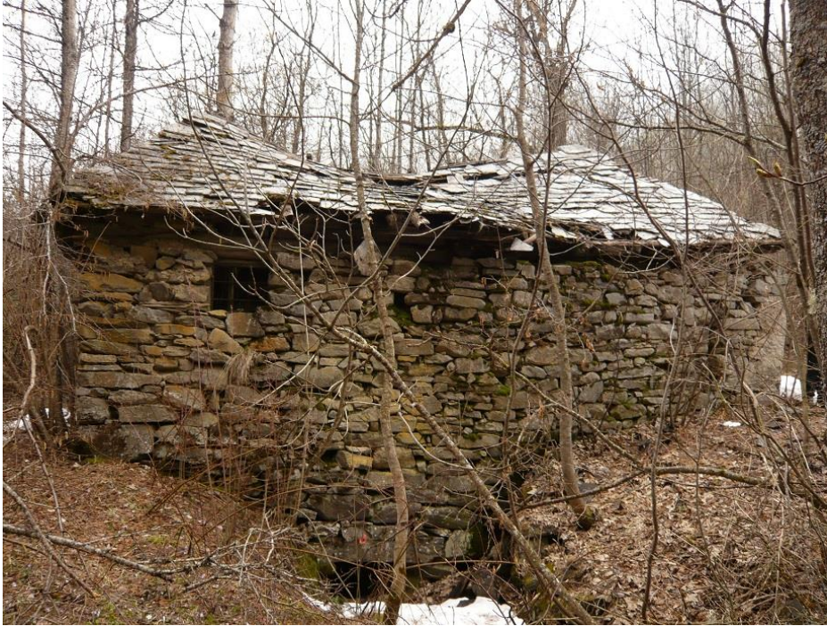
Figure 609 : Façade est du moulin. Au premier plan, le canal d'évacuation de l'eau qui rejoint le torrent de la Biaysse, situé à 30 m en aval. Sur cette photographie, l'affaissement de la toiture est particulièrement visible (les Viollins, Freissinières).
