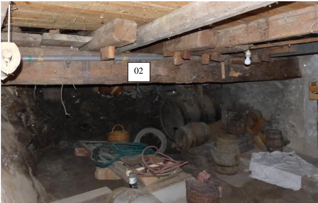
Figure 650 : Au niveau inférieur, la solive nord 02 est orientée est-ouest (les Queyras, La Roche-de-Rame).
