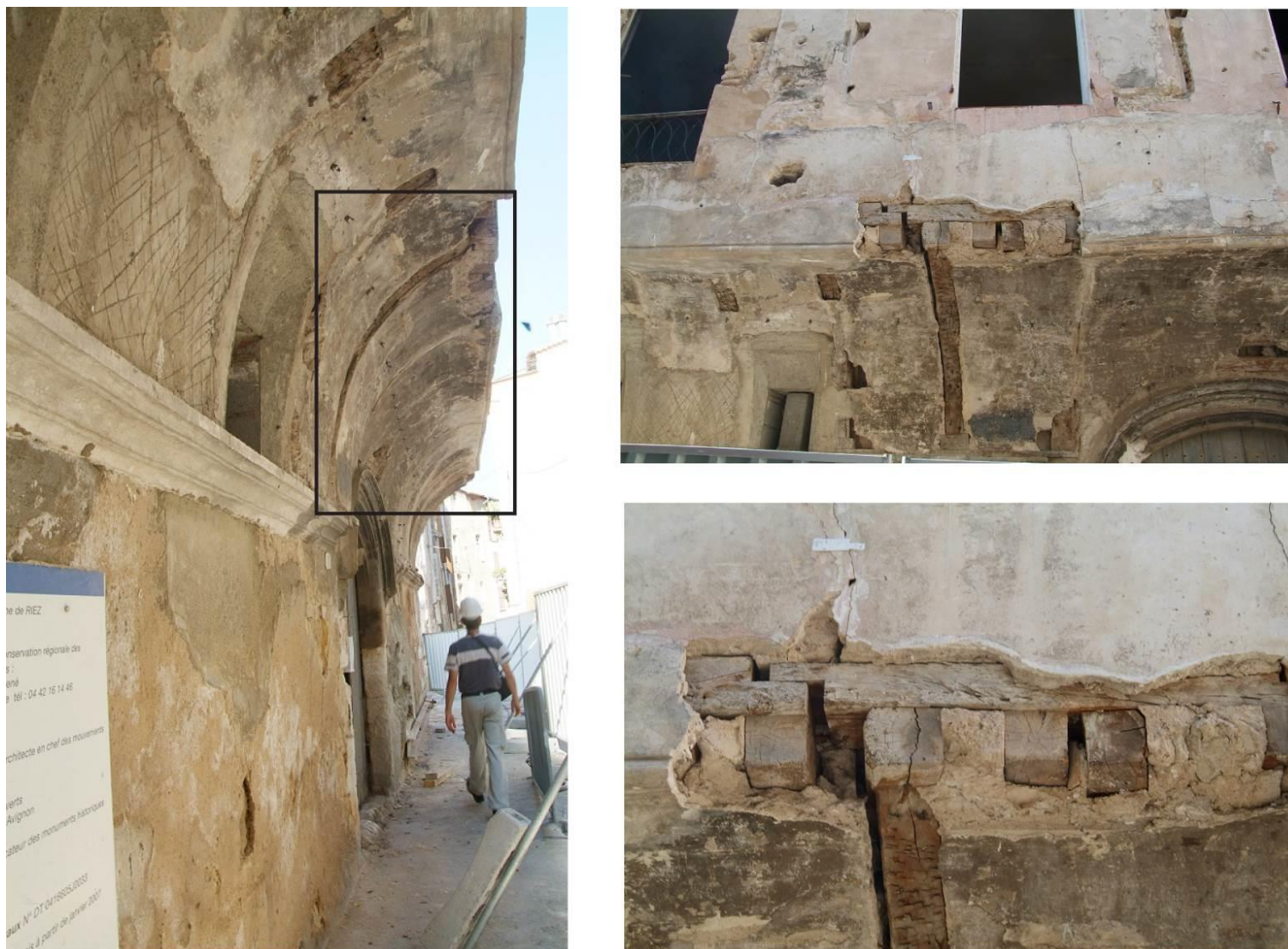
Figure 273 : Détail de l'encorbellement de la façade nord de l'hôtel Ferrier. La disparition de l'enduit permet de voir l'assemblage entre une des potences et la sablière, elle-même constituée de deux éléments assemblés à mi-bois droit.
