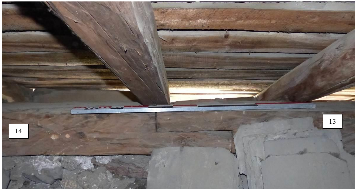
Figure 212 : détail de l'assemblage (enture à mi bois) des deux pièces de bois (14 et 13) constituant la panne sablière sud (église St-Laurent, La Roche-de-Rame).
