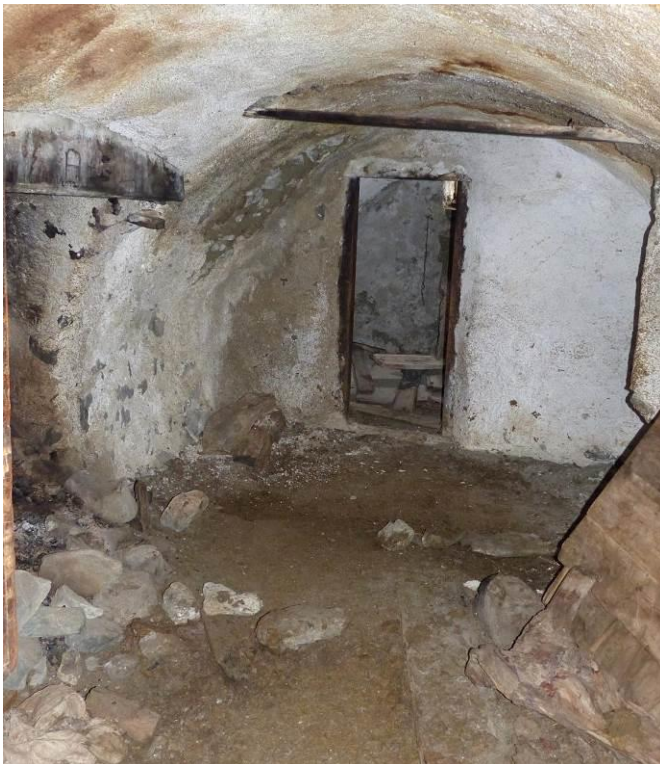
Figure 475 : Pièce voûtée (hauteur max : 2 m) au niveau inférieur, dans la partie nord-est du bâtiment (vue vers le nord-ouest). Une cheminée est installée dans le mur sud-ouest. On accède à cette pièce par la cour nord-est où a été réalisé le premier prélèvement, octobre 2013 (les Fraches, Cervières).
