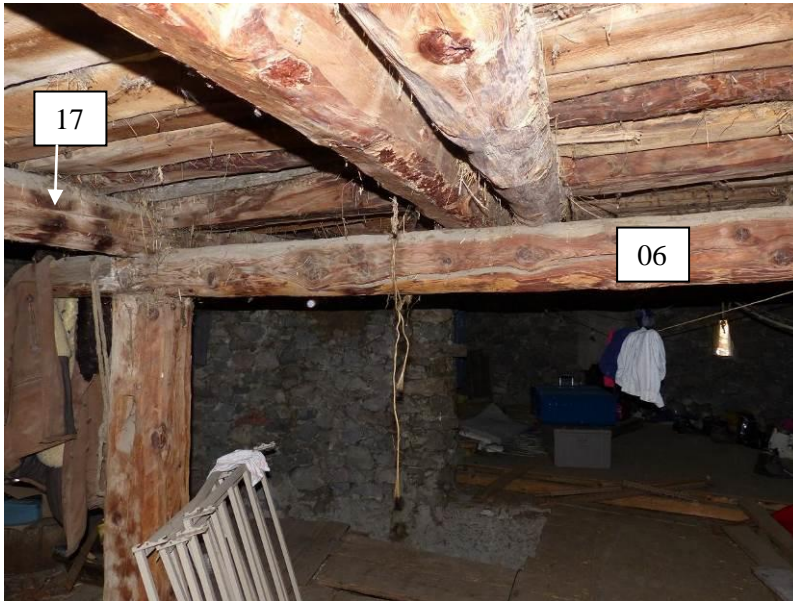
Figure 362 : Grange, N+2, partie est, vue vers le sud. La solive 17 repose sur la poutre 06. (Pra Premier, Val-des-Prés).
