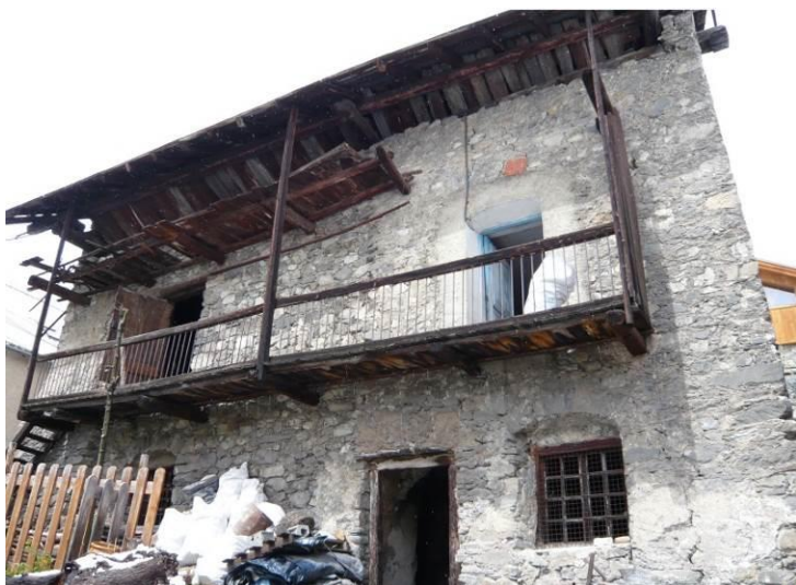
Figure 563 : Façade sud-est, le balcon donne accès à la grange étudiée (Prelles, St-Martin-de-Queyrières).
