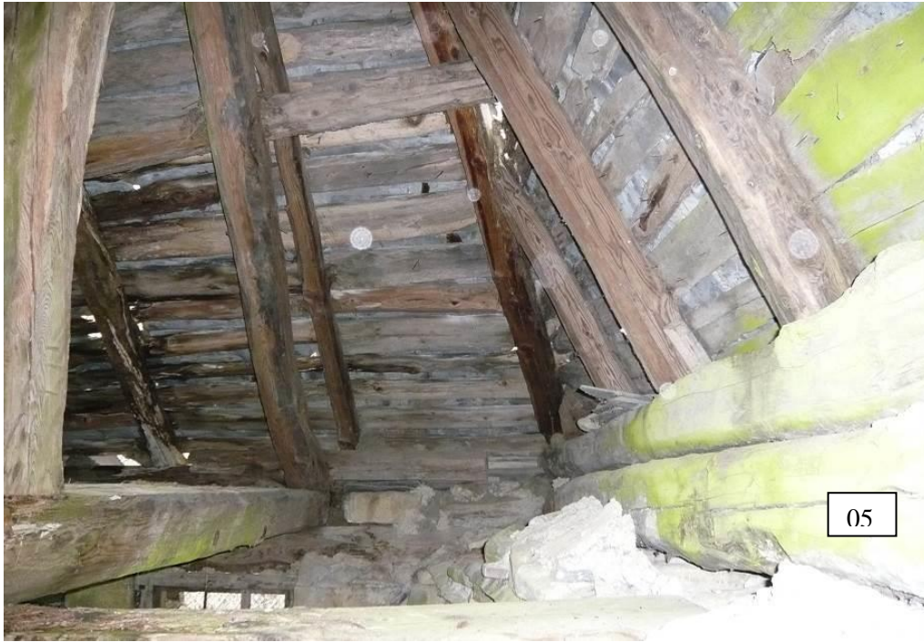
Figure 617 : La solive 05 est posée sur le mur sud, vue depuis l'ouest (les Viollins, Freissinières).
