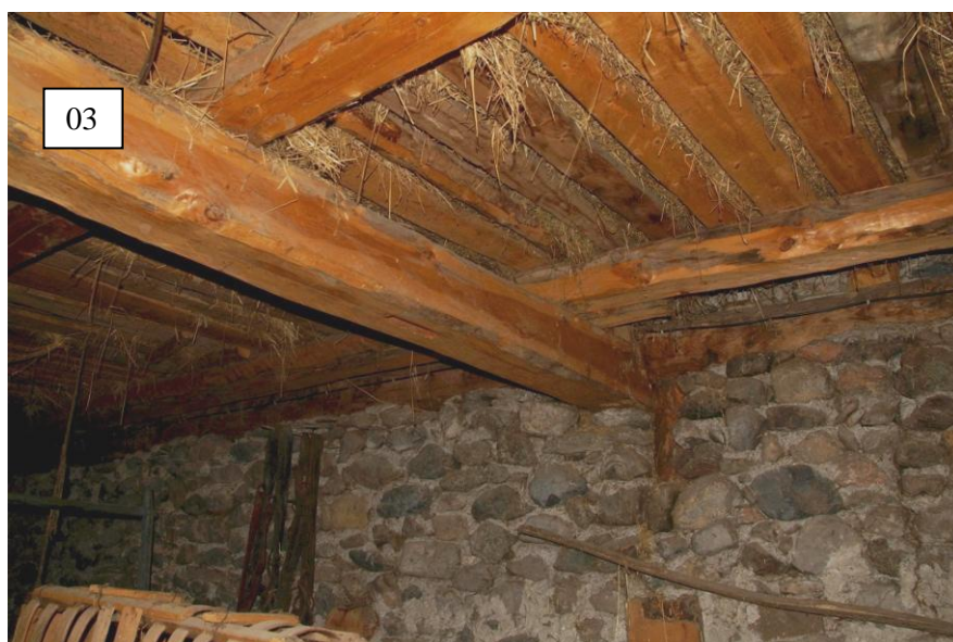
Figure 73 : Grange, niveau 4. Détail de la partie orientale de la solive 03 (le chef-lieu, Cervières).
