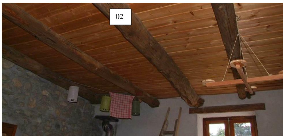
Figure 102 : Pièce à vivre du deuxième niveau vue vers le sud-ouest. La solive 02 est la troisième en partant du sud (la Maison Crénelée, Briançon).
