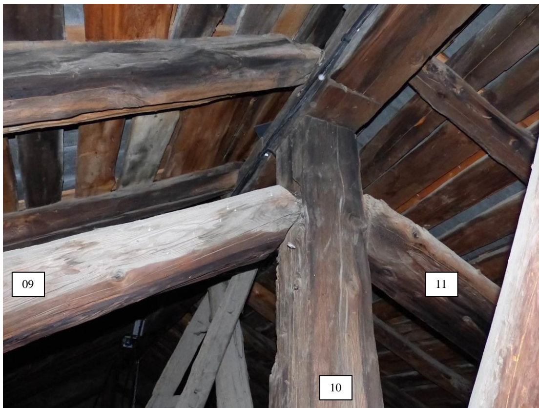
Figure 210 : Comme toutes les pannes de cette charpente, la panne faîtière est composée de deux pièces de bois distinctes, assemblées au niveau du poinçon de la ferme centrale (église St-Laurent, La Roche-de-Rame).
