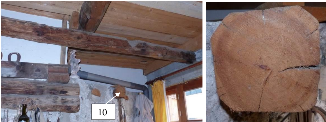
Figure 409 : Localisation et détail de la solive 10 dans le mur sud du deuxième niveau (salon actuel) (le Serre, Val-des-Prés).
