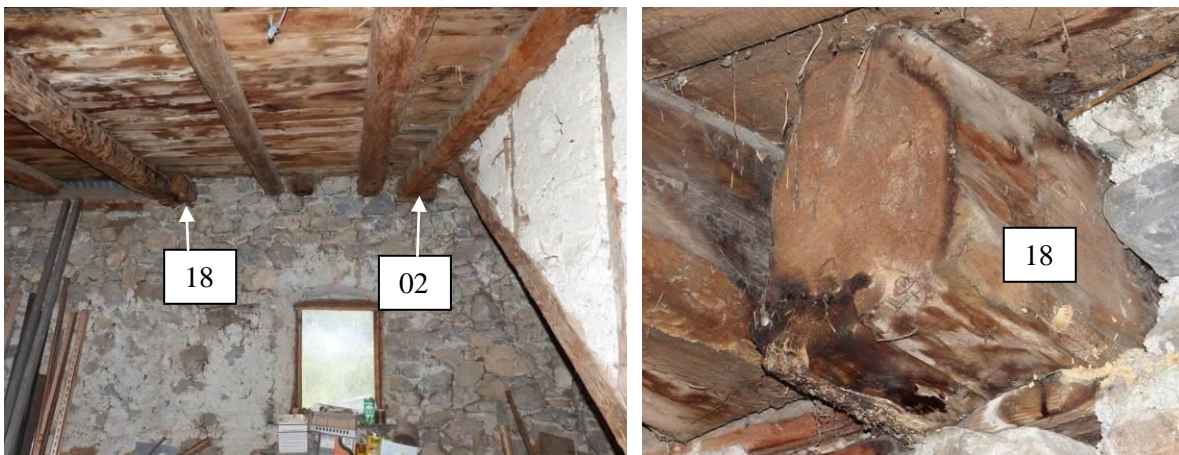
Figure 357 : Grange, N+1, mur est. A droite, détail de la poutre 18 (Pra Premier, Val-des-Prés).
