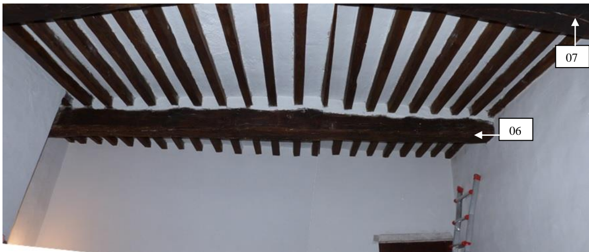
Figure 234: La poutre 06 est située près de la porte de la chambre côté ruelle, au deuxième étage (La Javie).
