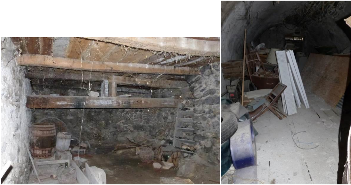
Figure 634 : Vues du cellier depuis l'est. A gauche, le niveau inférieur ; à droite, le niveau supérieur voûté (la Fare, La Roche-de-Rame).
