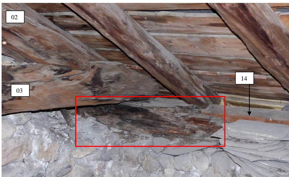
Figure 214 : Détail de l'extrémité sud de l'entrait de la ferme est. Il repose sur une calle de bois posée devant la panne sablière sud (église St-Laurent, La Roche-de-Rame).
