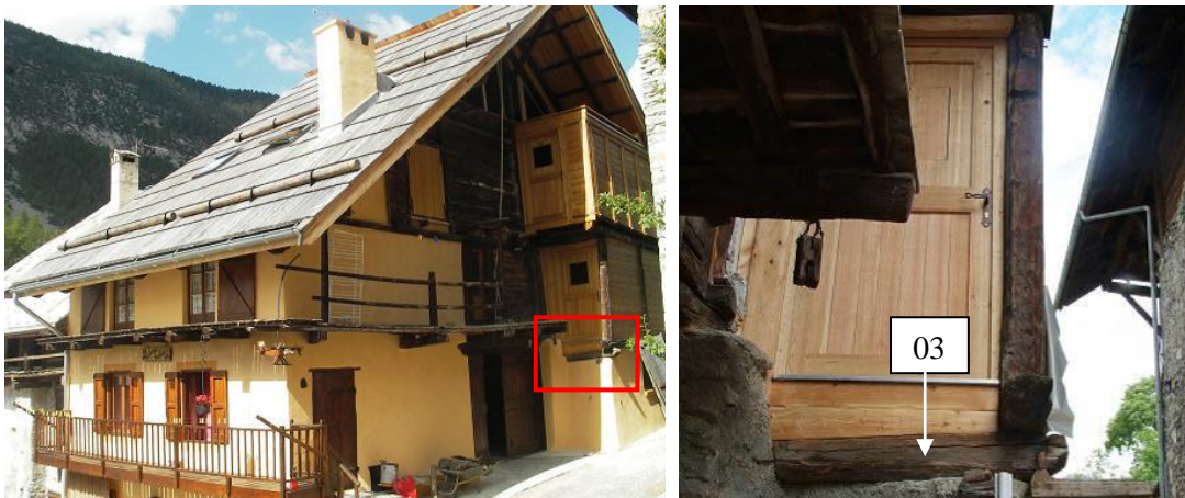
Figure 339 : Localisation du bois 03, au sud du ressaut de la façade nord-est (clichés N. Pecoraro et L. Shindo) (Plampinet, Névache).
