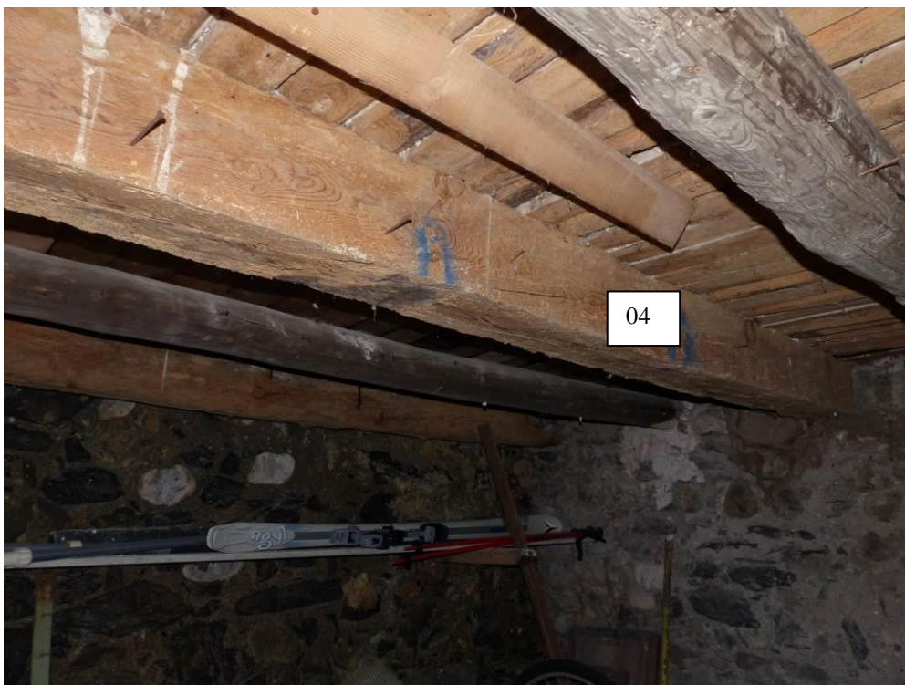
Figure 712 : Niveau 1 (caves), pièce centrale vue vers le sud-est (le Moulin, La Javie).
