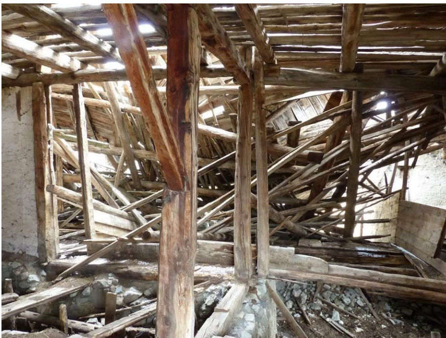
Figure 481 : Vue vers le sud depuis la grange ouest (deuxième niveau). Dans la partie inférieure de la photographie, on distingue à gauche les stalles de l'écurie sud-ouest et à droite, une pièce à la fonction indéterminée. Depuis cet angle, l'effondrement de la charpente sud est particulièrement visible (les Fraches, Cervières).
