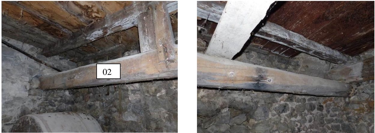
Figure 637 : Vues des extrémités sud et nord de la poutre 02, depuis l'est (la Fare, La Roche-de-Rame).
