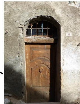
N, façade sud, porte donnant accès à la cour. A droite, détail de la grille en fer forgée qui la surmonte. Les extrémités supérieures des barres verticales se terminent par des fleurs de lys dont les extrémités latérales ont été repliées (peut-être un geste anti-royaliste).
