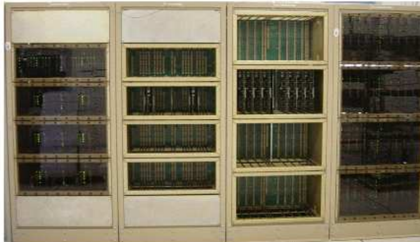
FIG. 1.36 – Armoire Corrélateur qui contiendra 1/8 des cartes de l'ensemble du système
