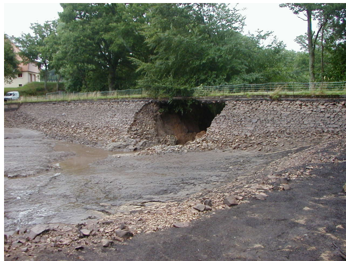
FIGURE 1.2: Exemple de brèche suite à l'érosion d'une digue (R. Frell et J.-J Fry [37]).
