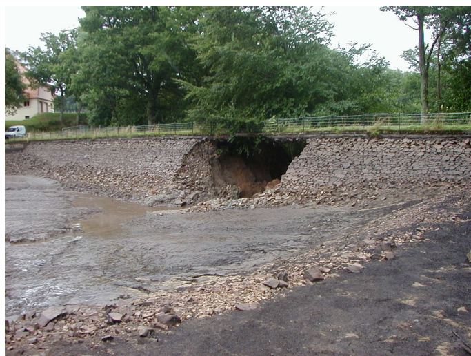
FIGURE 1.2: Exemple de brèche suite à l'érosion d'une digue (R. Frell et J.-J Fry [37]).
