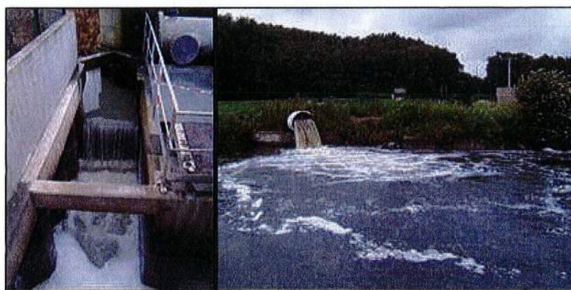
Figure 2. 4 : Station de relevage « Vallée de Scarpe ». A gauche : arrivée des eaux dans la station. A droite : rejet dans la Scarpe Inférieure.
