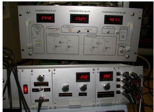
(b) Charge active 5-10kW (en haut) avec module de contrôle-commande (en bas)
